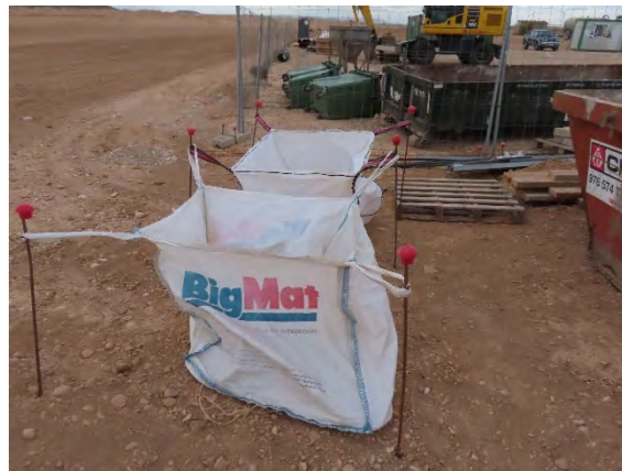
Contenedores de residuos no peligrosos en el nuevo punto limpio de Cobra.
