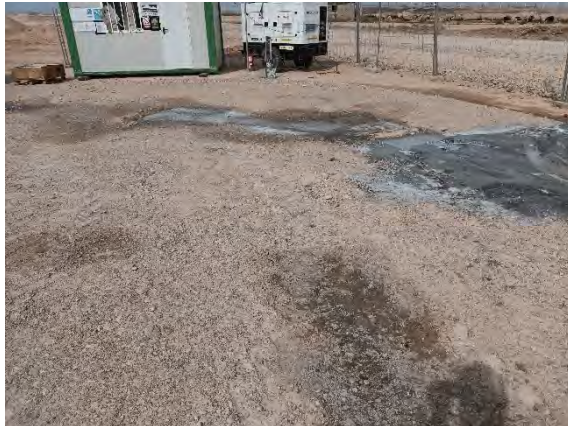
Vertido de aguas de lavado de herramientas/maquinaria impregnada de hormigón sobre el suelo en punto limpio. Retirada de inmediato.
