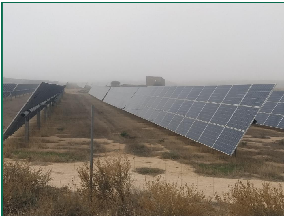
Fotografía 1. Vegetación entre placas actualmente.
