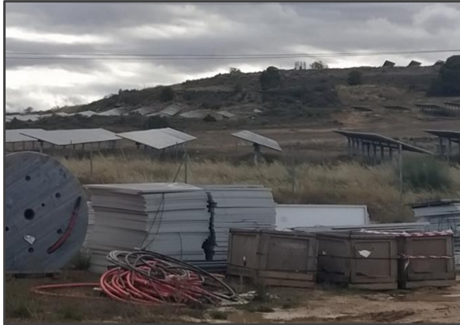
Fotografía 4. Zona de acopio de placas solares deterioradas.
