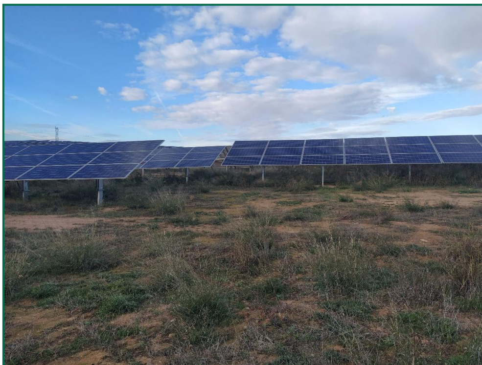
Fotografía 1. Vegetación entre placas actualmente.
