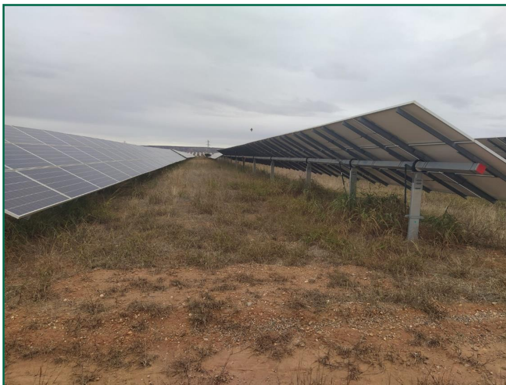
Fotografía 1. Vegetación entre placas actualmente.
