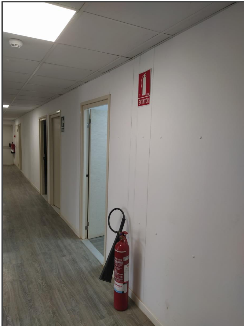
Fotografía 7. Extintores en edificio de control.
