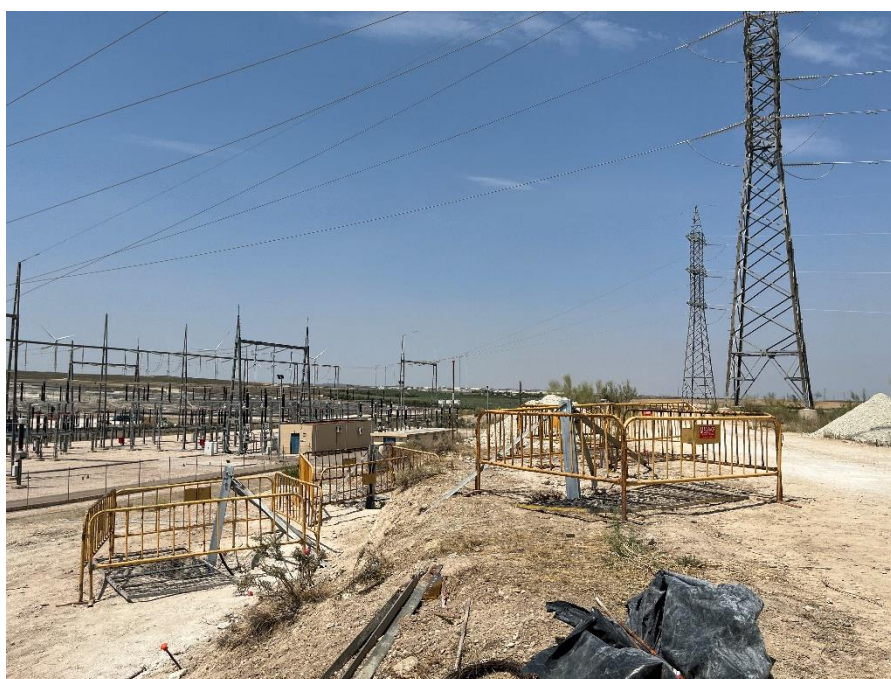
Figura 8 Apoyo 1 CS Ave- SET Ave
