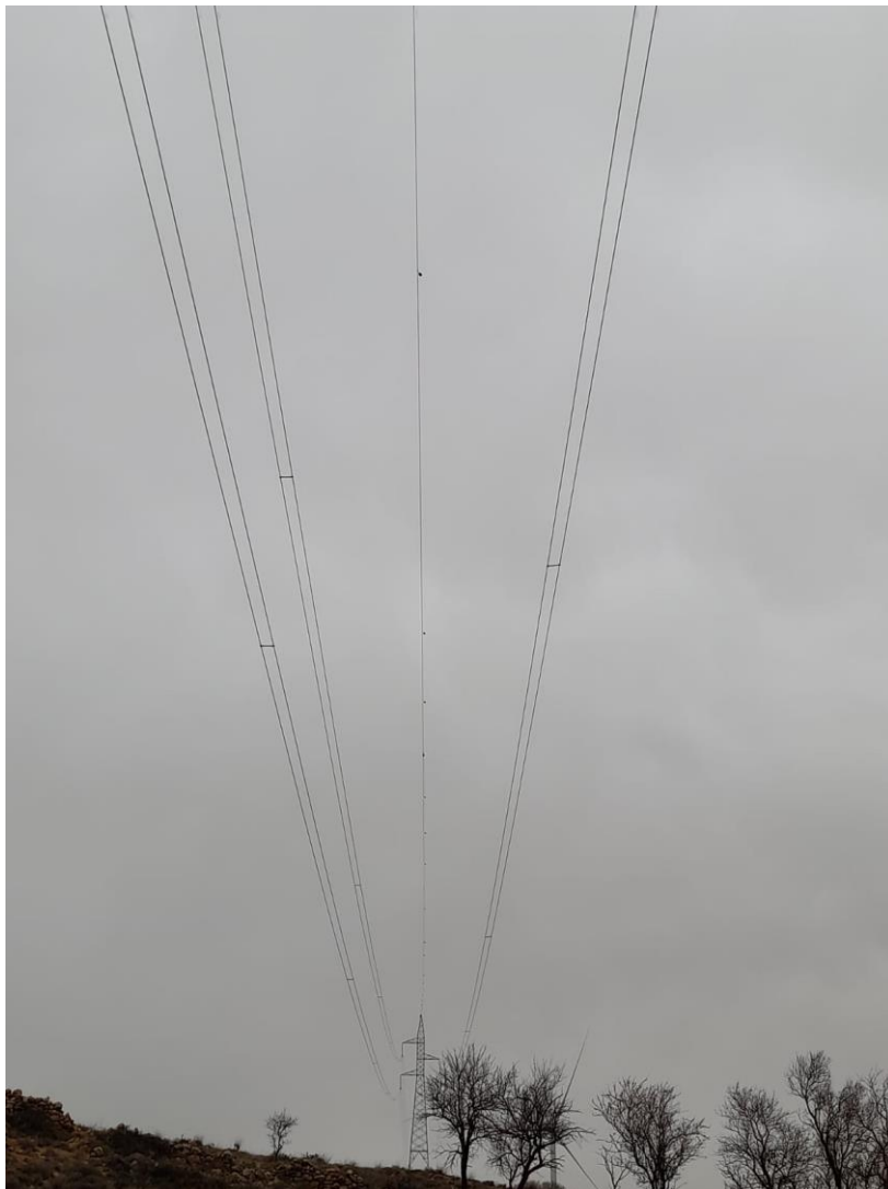
Fig 3. Tramo LAAT 07-06 En el que se observan como faltan balizas.
