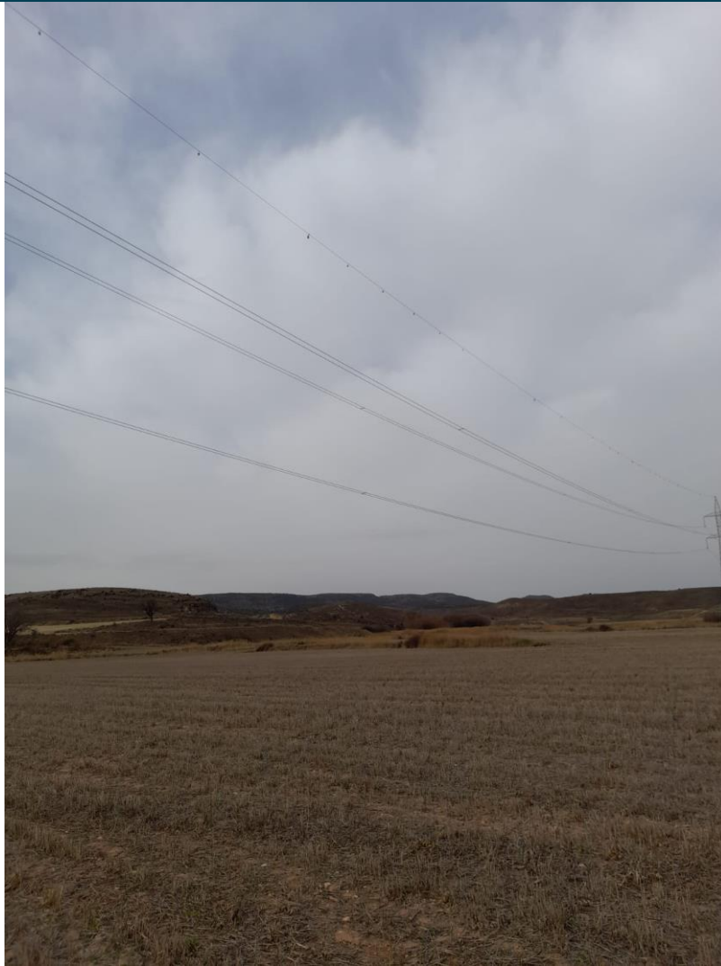
Fig 3. Tramo LAAT 32 - 31 En el que se observan como faltan balizas.
