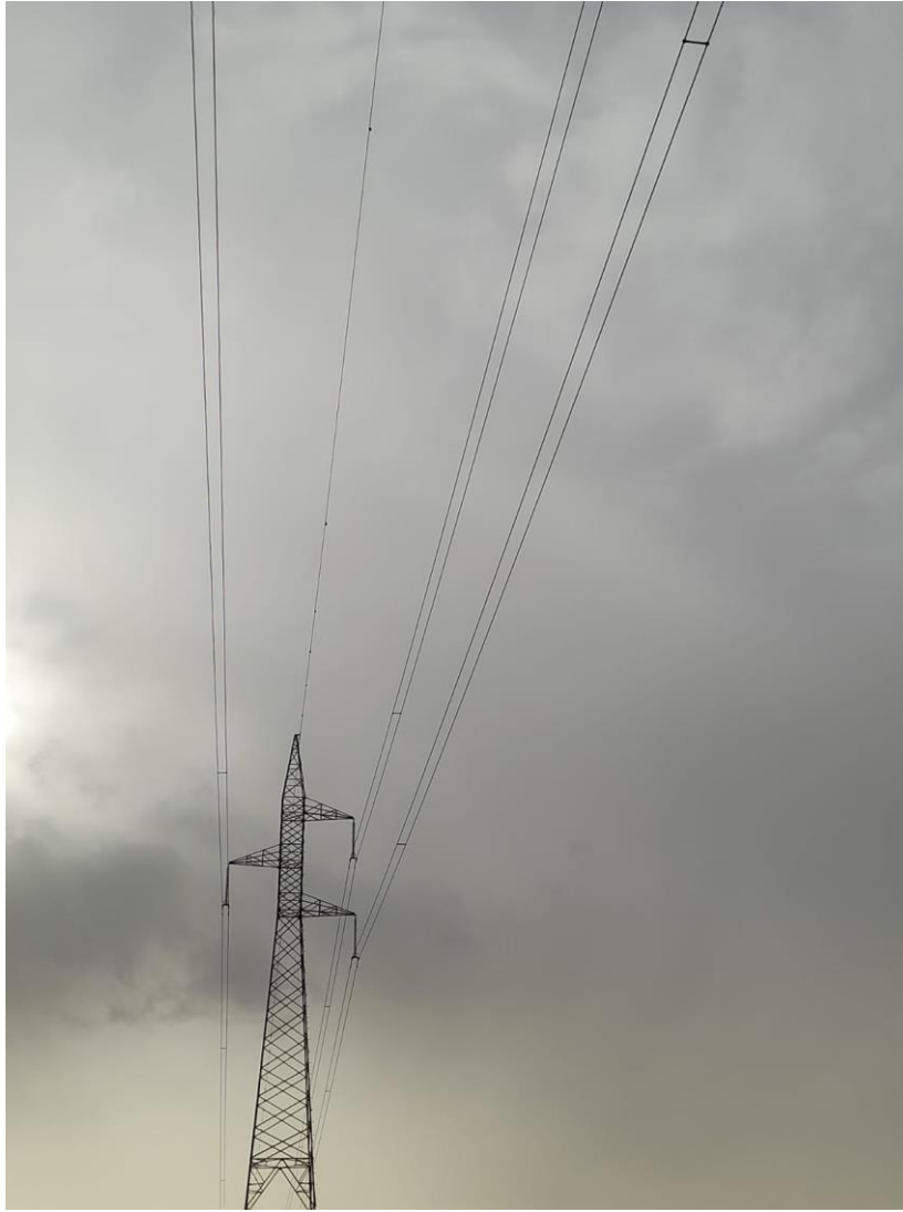
Fig 3. Tramo LAAT 25 - 24 En el que se observan como faltan balizas.
