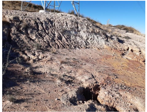
Fig. 2 Plataforma AP20 con cárcava al pie de su plataforma. Fuente: Elaboración propia
