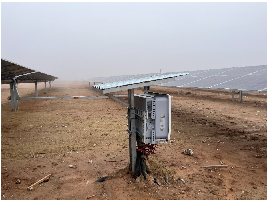
Figura 8 Cubierta de los inversores
