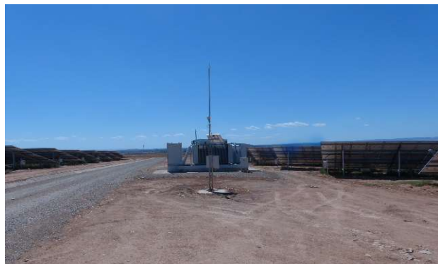
Foto 6. Vista de los paneles fotovoltaicos.
