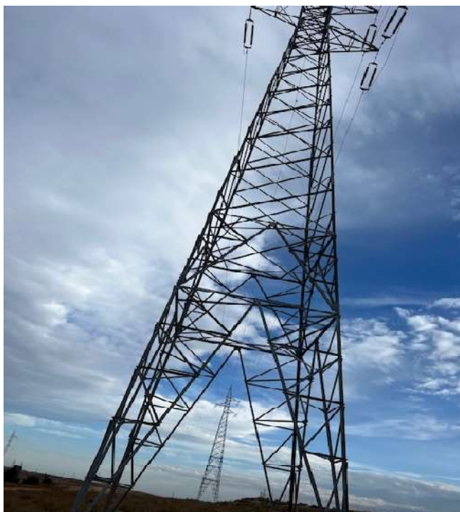
Fotografía 5: Se observan salvapajaros.
