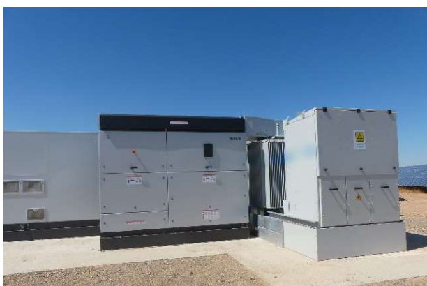
Foto 7. Vista de los transformadores de energía de la planta
