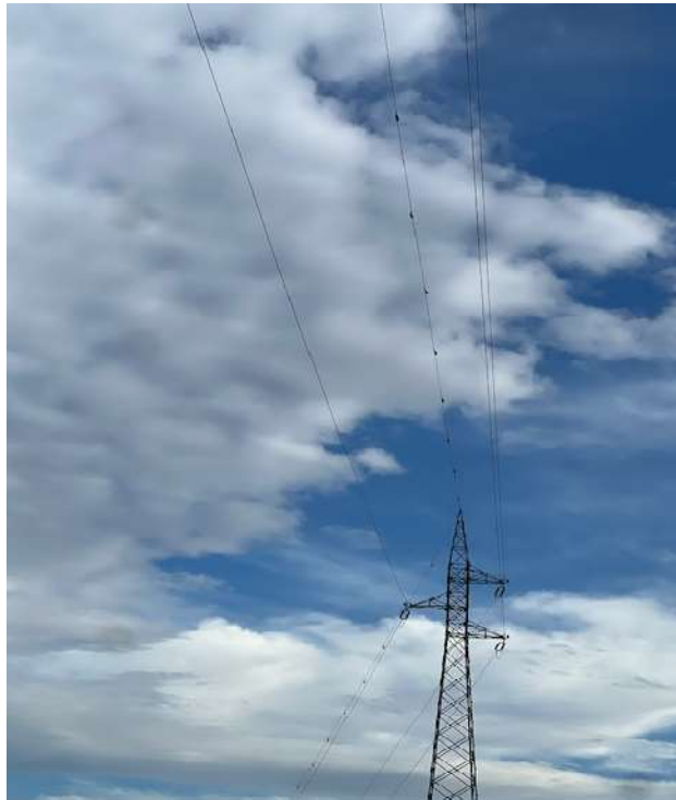
Fotografía 6: Se observan salvapajaros.
