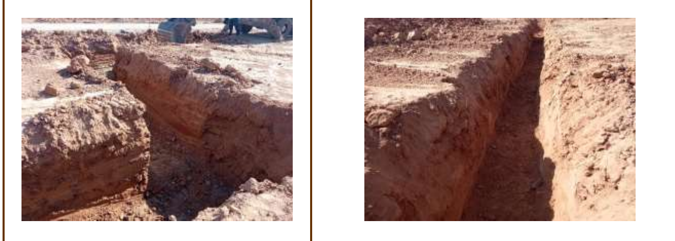
Fot. 1 y 2. Realización del zanqueo de BT en Zonas 8 y 9 de PSFV Pitarco A Oeste
