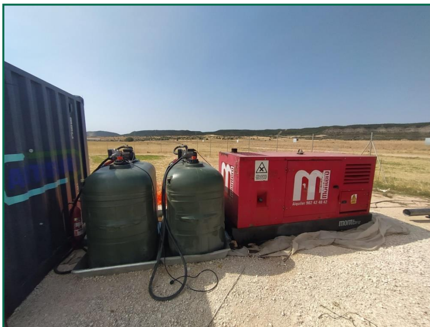
Fotografía 11. Bandejas para evitar derrames accidentales sobre el terreno.
