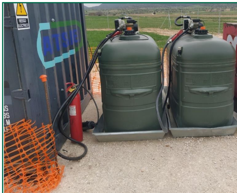
Fotografía 12. Extintor junto a contenedores de combustible.
