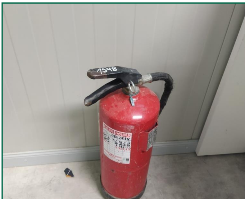
Fotografía 13. Extintor en el interior de las oficinas.
