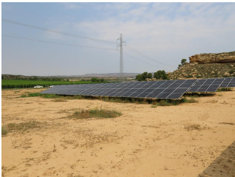
Foto 2. Vista general de la planta fotovoltaica
