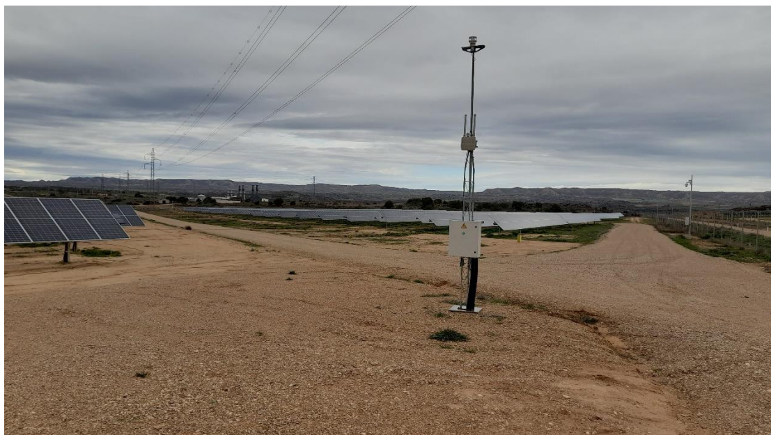
Foto 2. Vista general de la planta fotovoltaica
