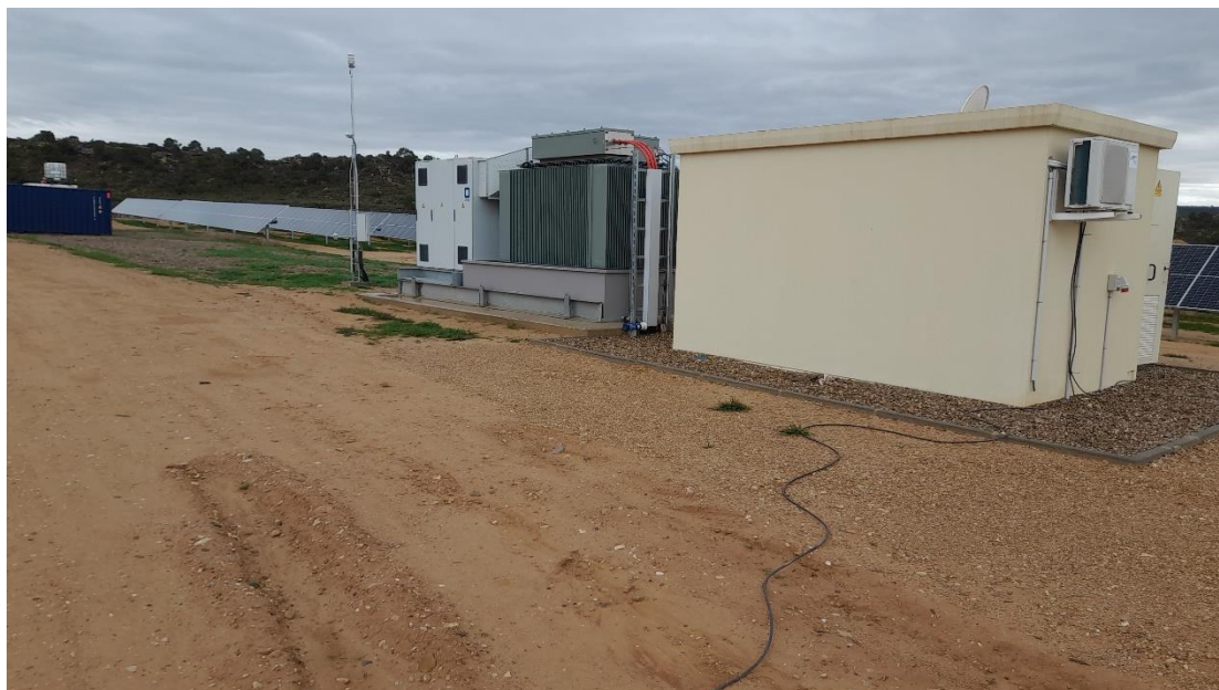
Foto 3. Centro de Transformación y celdas
