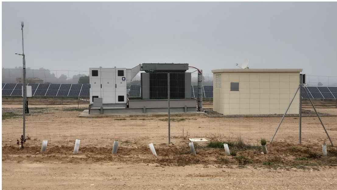
Foto 2. Centro de Transformación y celdas
