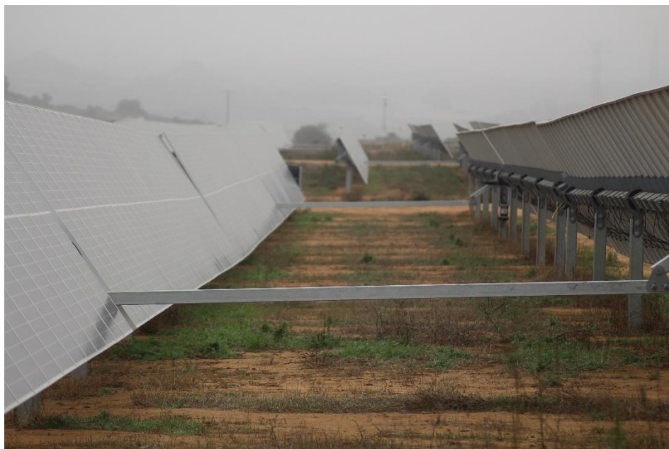
Foto 5. Vista de seguidores y vegetación natural incipiente creciendo entre ellos. Se puede apreciar una cobertura menor que en la fotografía anterior.
