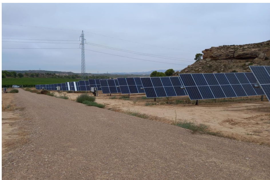
Foto 7. Vista de la planta fotovoltaica y vial interior.
