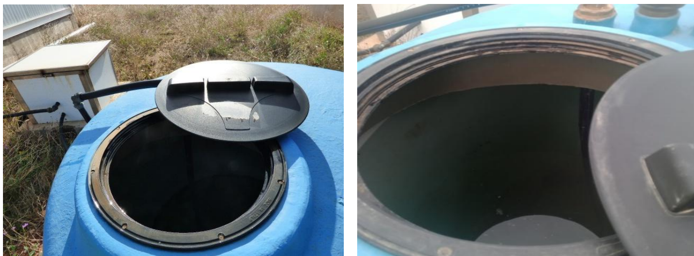
Imágenes 4 y 5 : Depósito de agua limpia, vista externa e interna (imágenes izquierda y derecha respectivamente)
