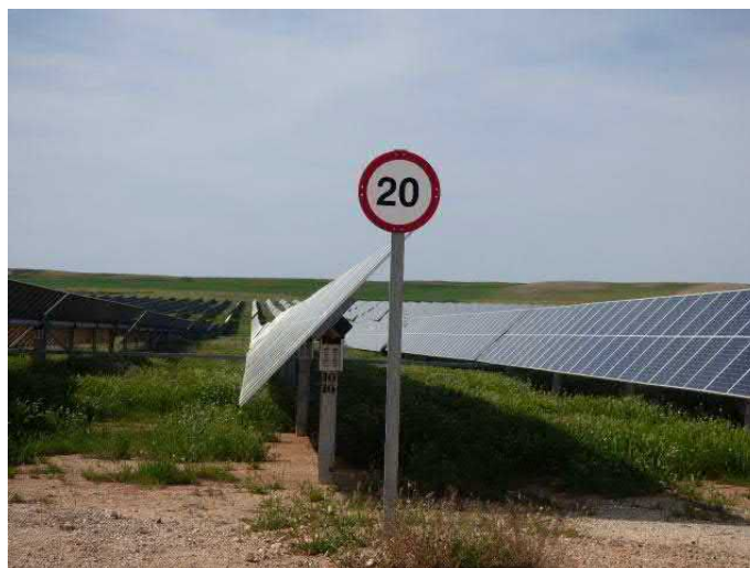
Imagen 10: Señal de límite de velocidad situada en uno de los viales del parque fotovoltaico.
