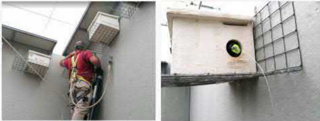
Instalación de tapones confeccionados con pelotas de tenis reutilizadas, cáncamos y cables de acero
