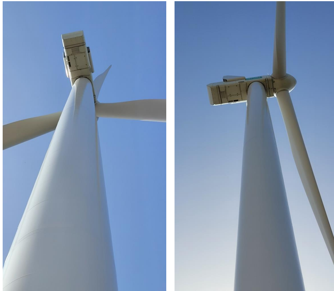
Fotografía 3 y 4: Barquillas de los aerogeneradores sin derrames de aceite
