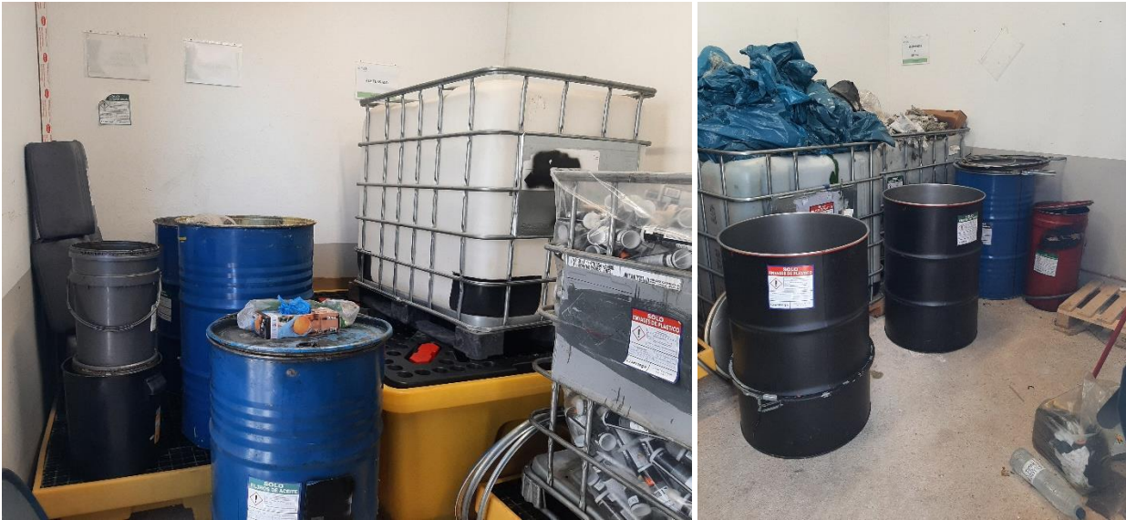
Punto limpio habilitado en la subestación Oriche para los parques eólicos de Oriche, Allueva y Sierra Pelarda.
