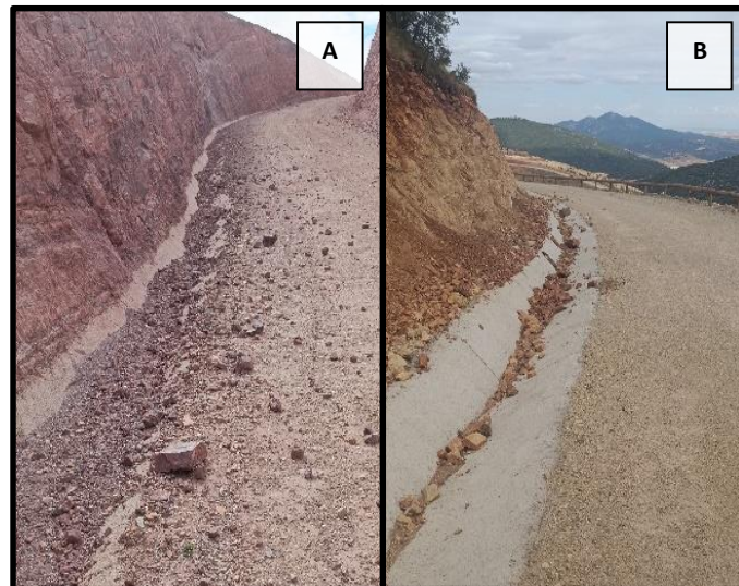
Fotografía 2. Desprendimiento de material en el vial de acceso a la turbina PDH-01 (A) y en el vial entre el aerogenerador PDH-05 y la torre meteorológica (B).
