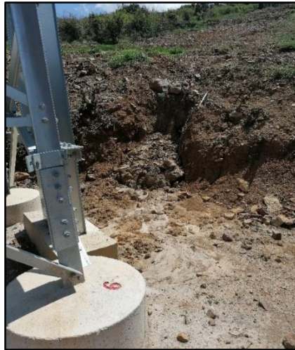
Fotografía 3. Pequeña escorrentía junto al apoyo LPDH-06
