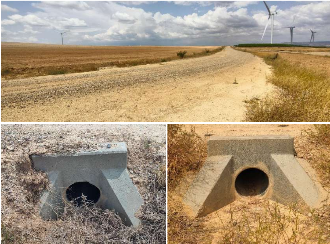
Foto nº10.: Drenaje de vial de acceso PE-03.
