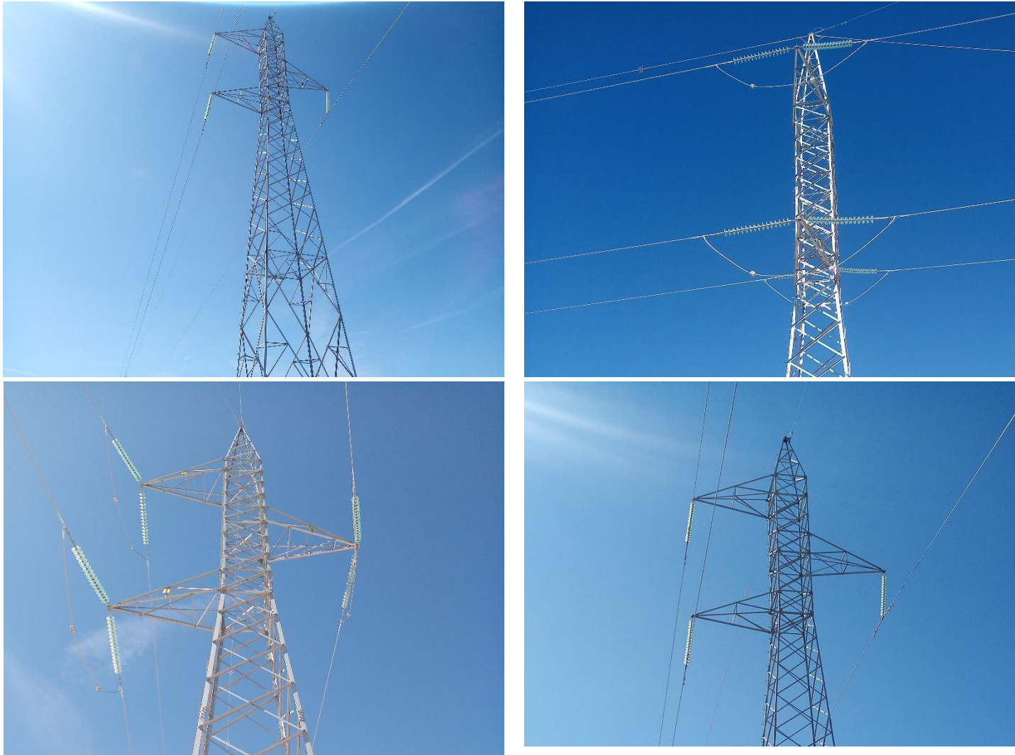
Fotografías 37 a 40: Apoyos y aisladores
