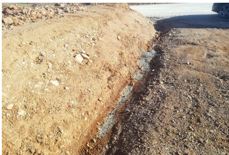
Foto 1 Derrame de hormigón en la plataforma del aero WTG-02.
