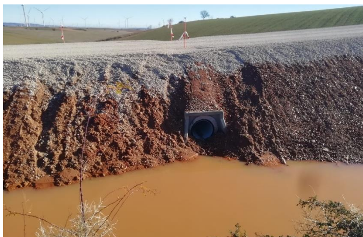
Foto 1 Agua de lluvias estancada.
