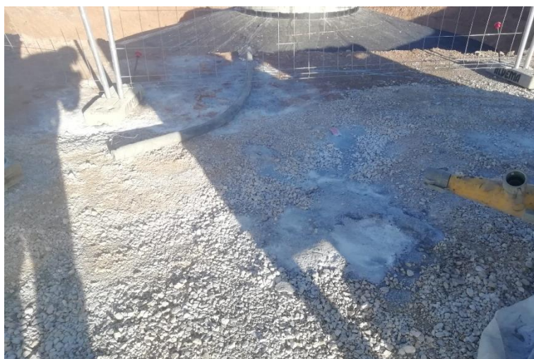
Foto 1 Derrame de hormigón en la plataforma del aero WTG-07.
