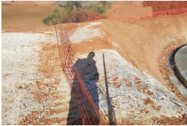
Foto 3 Restos de hormigón en WTG 05
