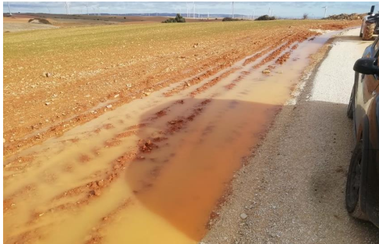
Foto 4 Agua de lluvias estancada.
