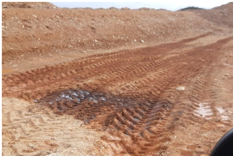
Foto 1 Derrame de betún en el acceso a la cimentación 4.
