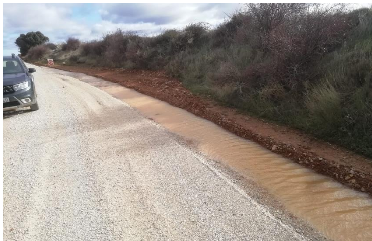
Foto 7 Agua de lluvias estancada.
