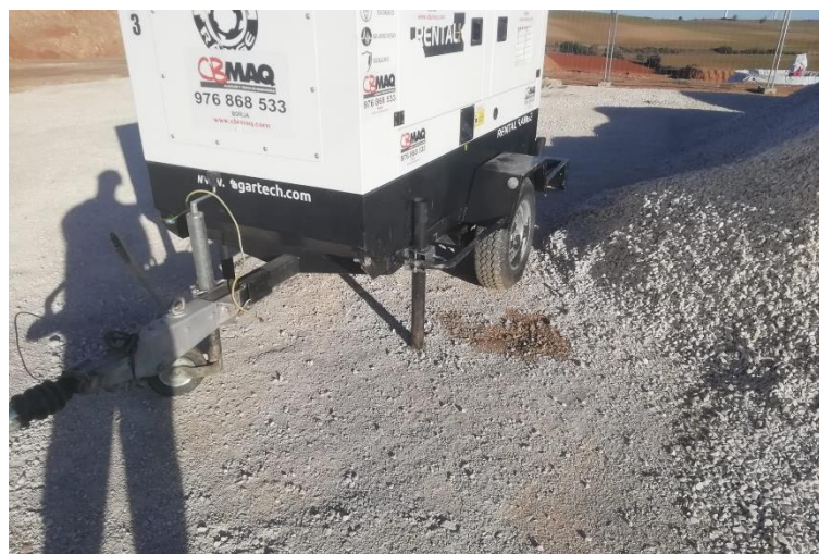
Foto 1 Derrame de aceite en la plataforma del aero WTG-07.
