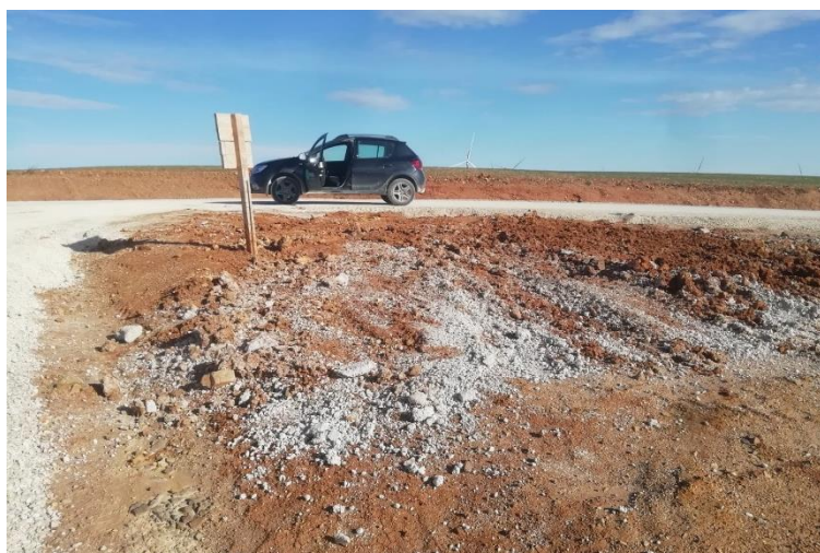
Foto 1 Restos de hormigón en la zona de lavado de WTG-01.
