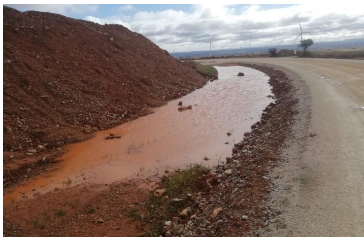
Foto 2 Agua de lluvias estancada.
