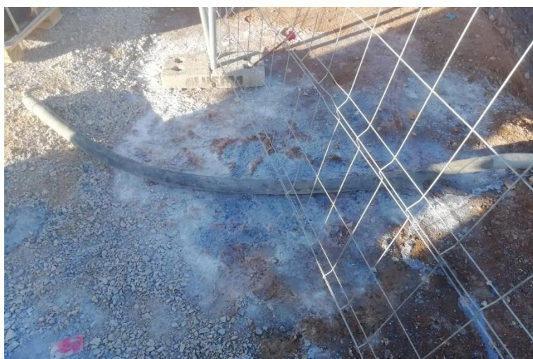
Foto 2 Derrame de hormigón en la plataforma del aero WTG-07.
