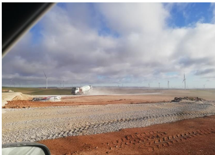
Foto 1 Polvo generado por hormigonera.
