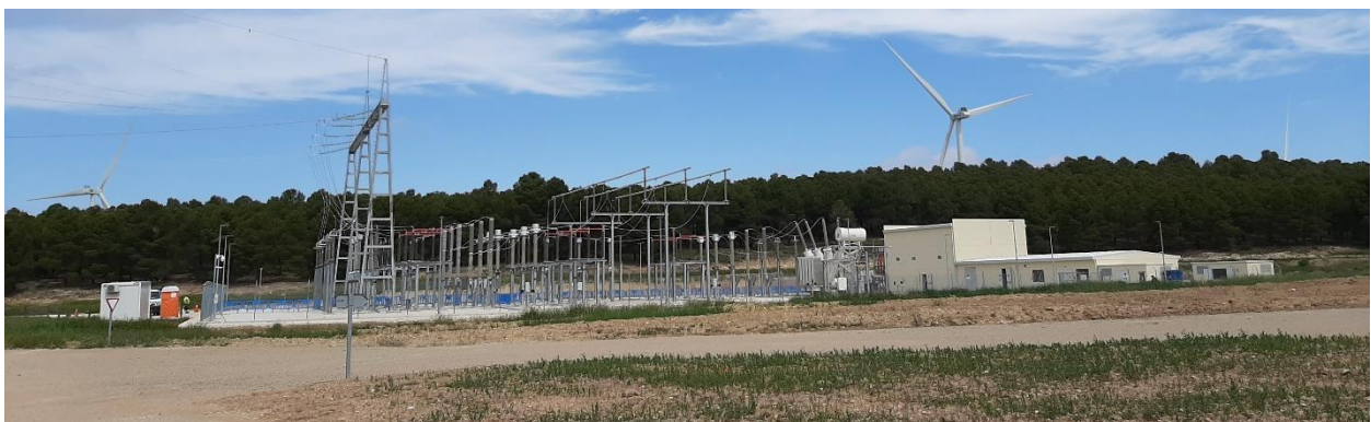
Figura 1: Vistas de la subestación Cañaseca.
