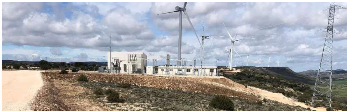
Figura 2: Vistas de la subestación Oriche
