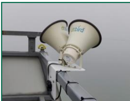
Fotografía 22. Sistema de anclaje de los altavoces.
