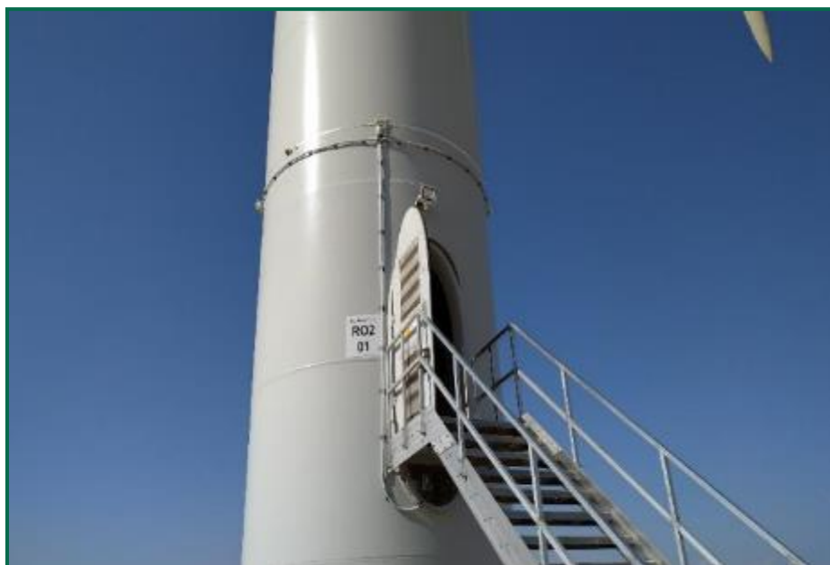
Fotografía 1. Nuevo sistema W4-D10, instalado.
