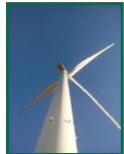
Fotografía 17. Sistemas de detección y disuasión instalado en aerogenerador.
