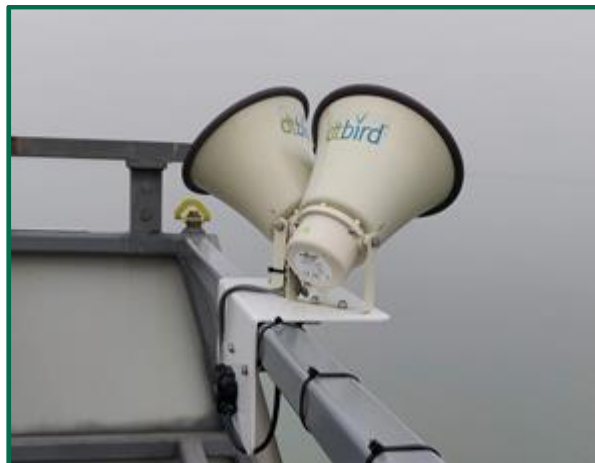
Fotografía 21. Sistema de anclaje de los altavoces.
