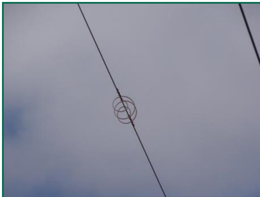
Fotografía 15. Detalle del sistema anti pájaros de la LAAT de evacuación.
