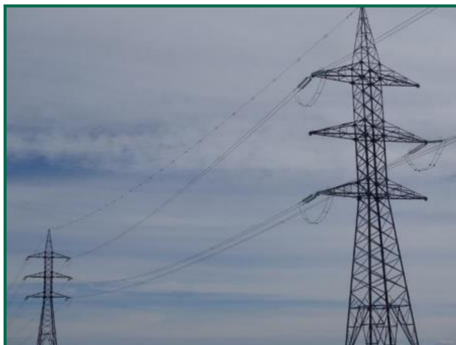
Fotografía 14. Apoyos de la LAAT de evacuación
