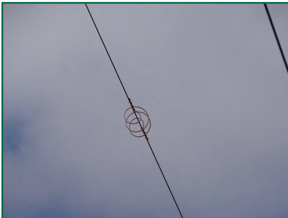
Fotografía 7. Detalle de balizas salvapájaros.
