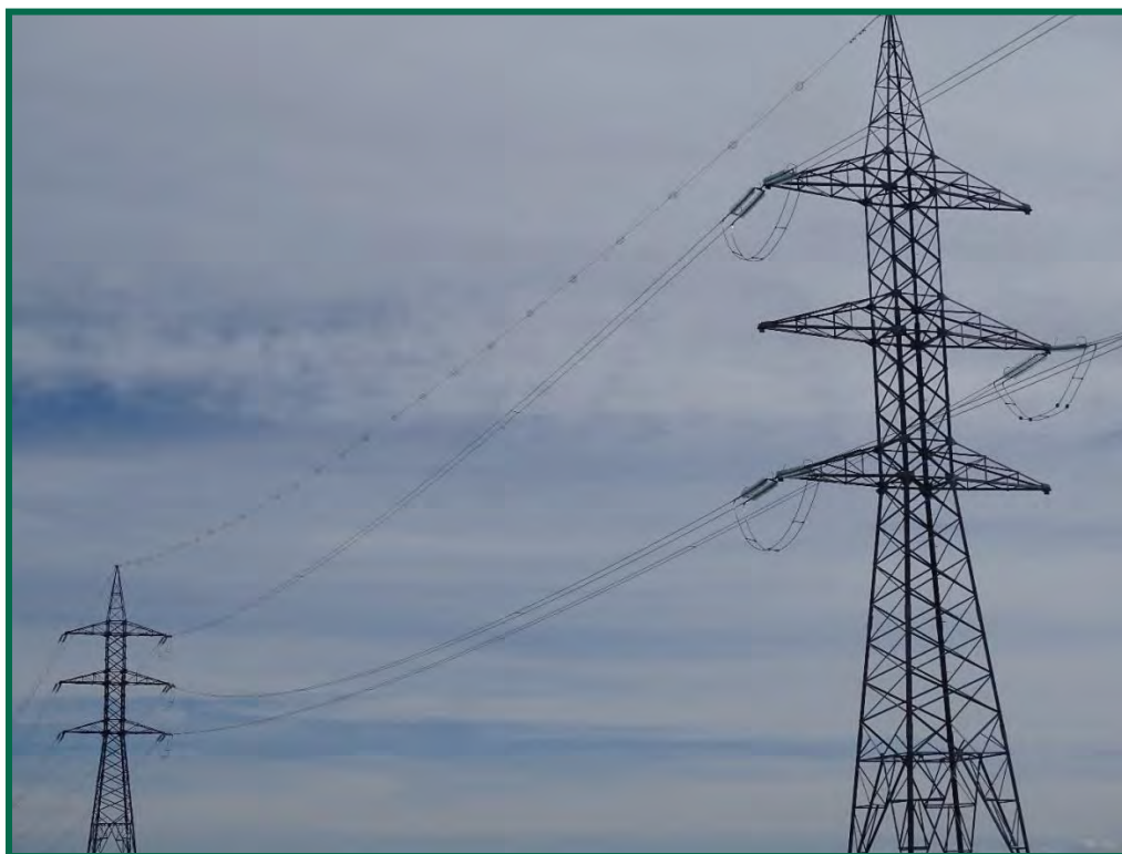
Fotografía 6. Apoyos LAAT evacuación.
