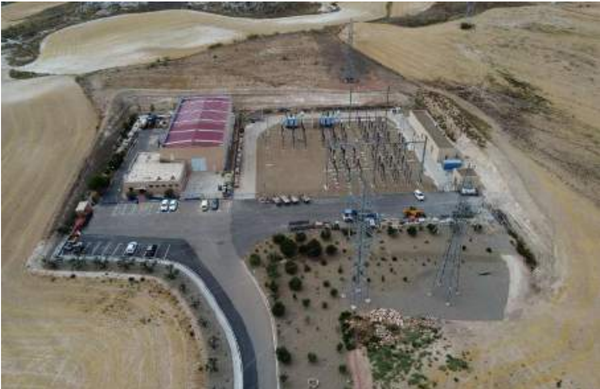
Foto nº19.: SET Bayo. Punto final de la LAAT.
