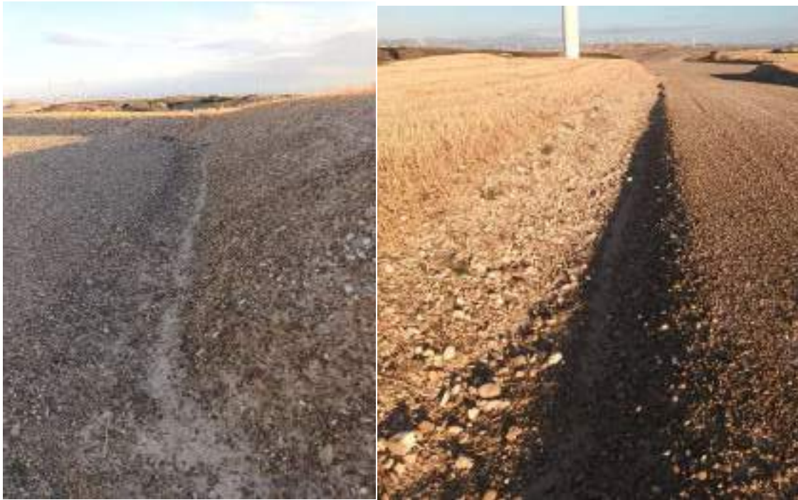
Foto nº33.: T-02: Drenaje en la plataforma.
