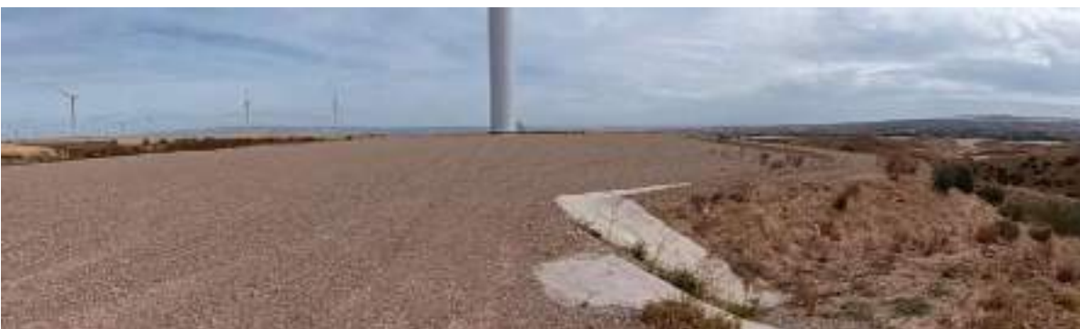
Foto nº39.: T-14: Drenaje en la plataforma.
