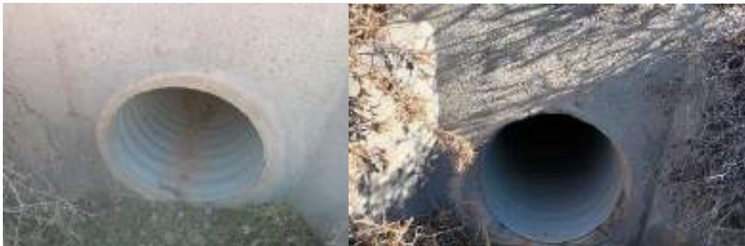
Foto nº41.: Detalle: Drenaje de vial de acceso PE.
