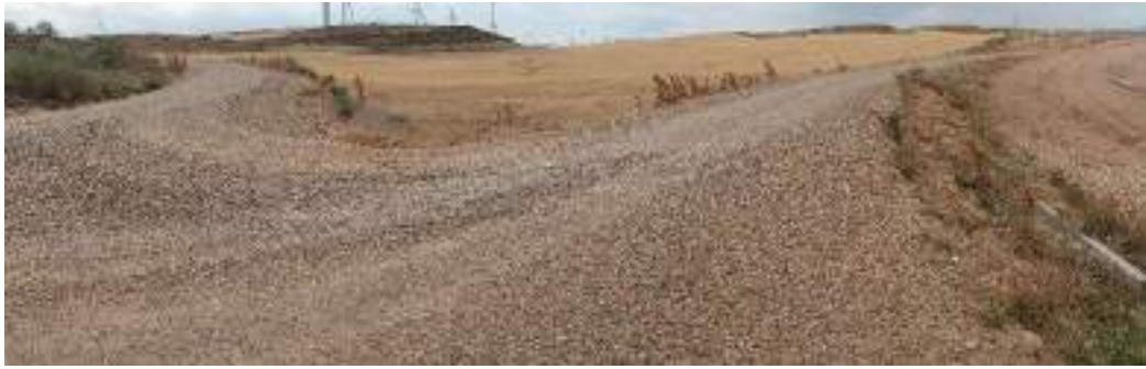
Foto nº40.: Drenaje de vial de acceso PE.
