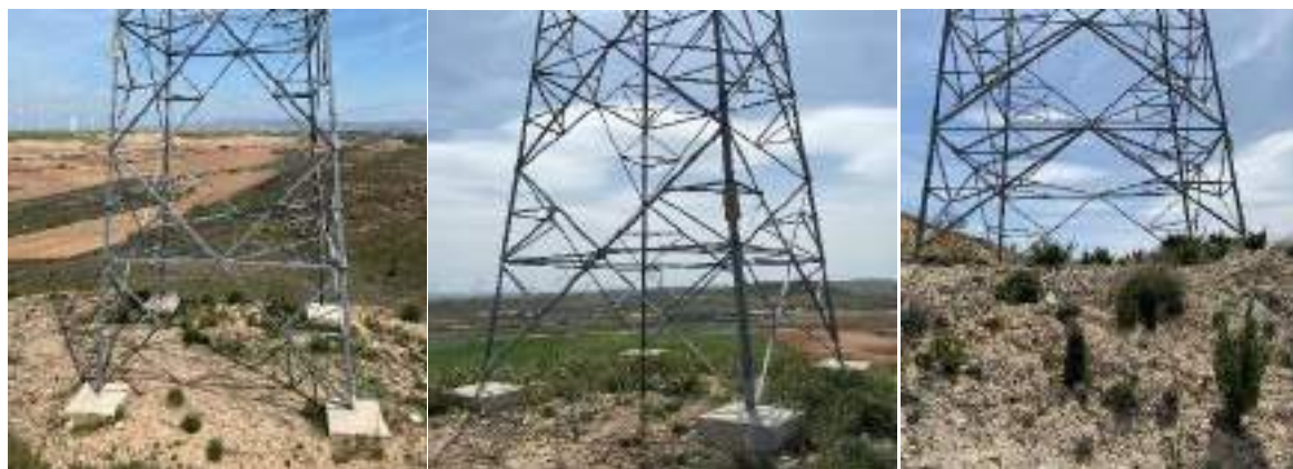
Foto nº17.: Estado general de los apoyos. Ejemplo del Apoyo nº 14, nº 18 y nº 19 de la LAAT.
