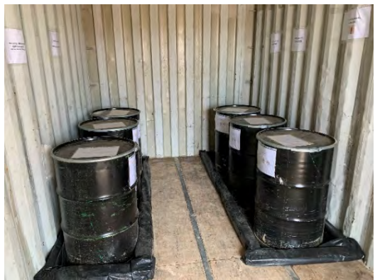
Figura 21 Punto limpio de residuos peligrosos
