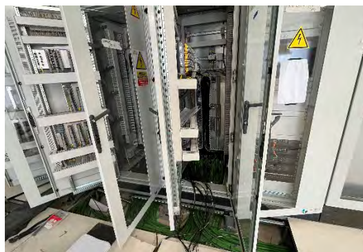
Figura 12 Cableado de los armarios CS Ave
