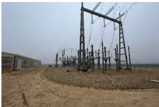
Figura 11 Cableado de la SET Fuentes
