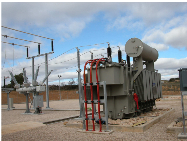
Transformador en subestación eléctrica de 20 MVA (Valderrobres, Teruel)
