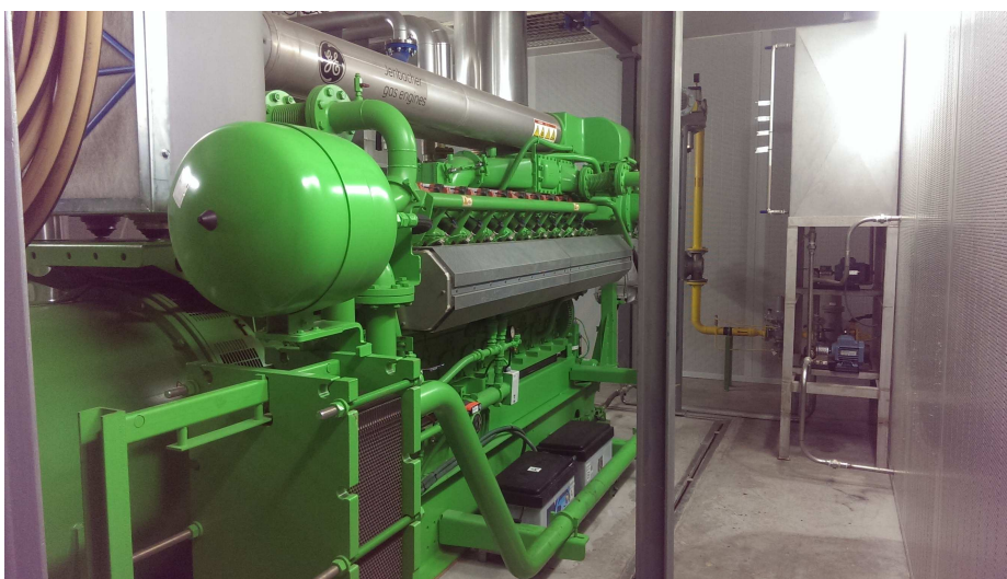
Motores de central de trigeneración de 1 MW (Mallén, Zaragoza)
