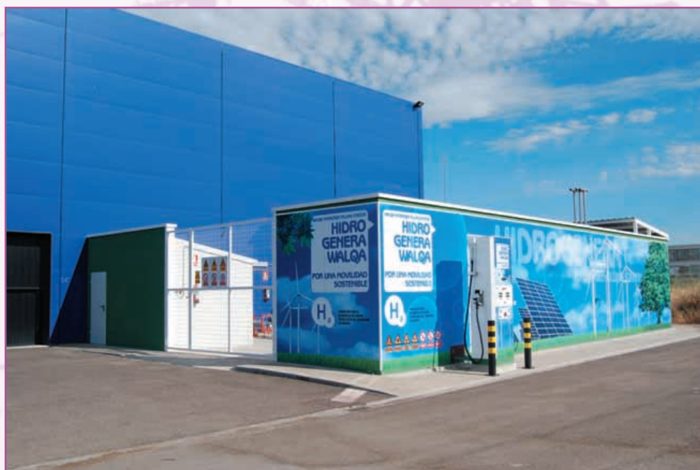
Vista general de instalación de repostaje de hidrógeno en Fundación del Hidrógeno en Walqa (Huesca)
