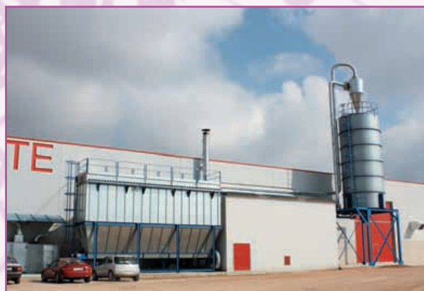
Caldera de biomasa en empresa Escaleras Yuste, en Monreal del Campo (Teruel)
