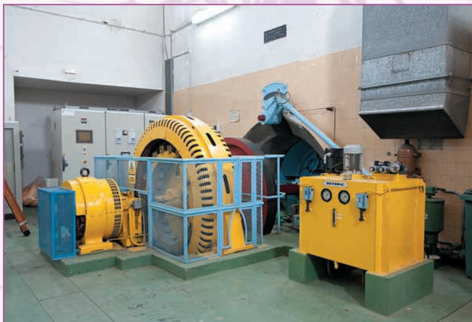
Minicentral hidroeléctrica en San Mateo de Gállego
