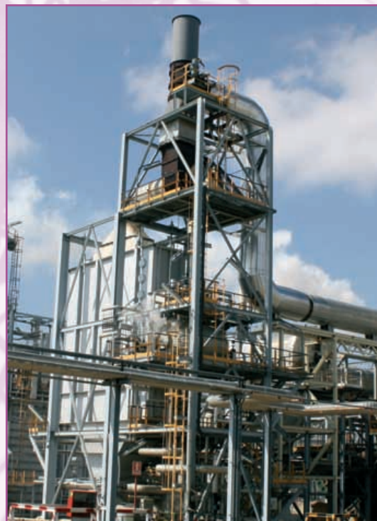
Central de cogeneración de gas natural y biomasa en empresa UTISA en Cella (Teruel)
