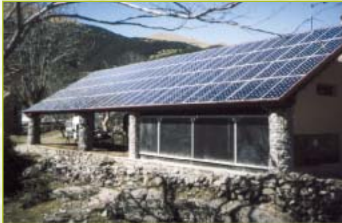
Energía Solar Fotovoltaica centralizada en Escuaín (Huesca)
