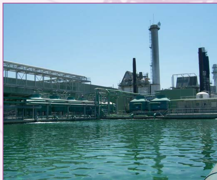
Planta de cogeneración de biogás de 7,50 MW en Saica
