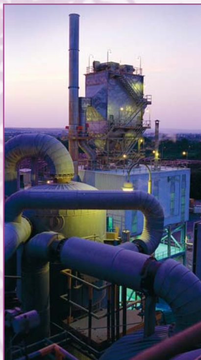
Cogeneración con residuos de madera. La Montañanesa, S.A. (Zaragoza)
