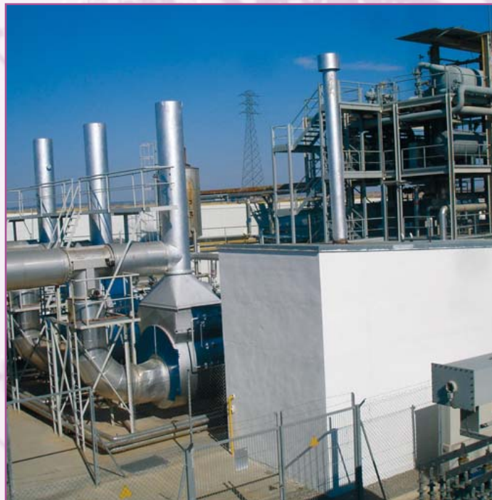
Planta de cogeneración. Cogeneración del Ebro, S.A. (Zuera, Zaragoza)
