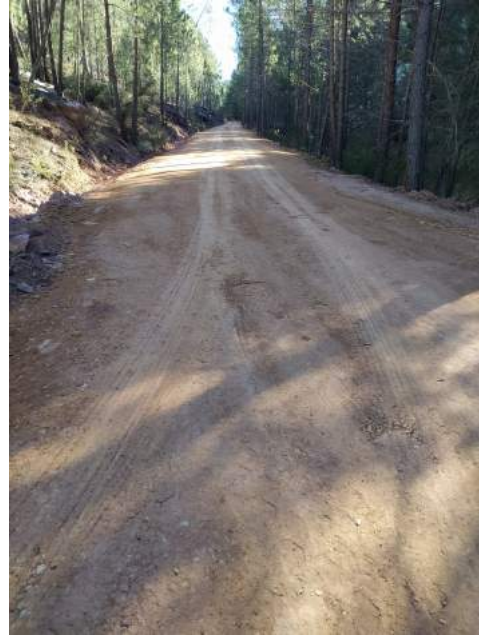
Estado final del firme de la pista
