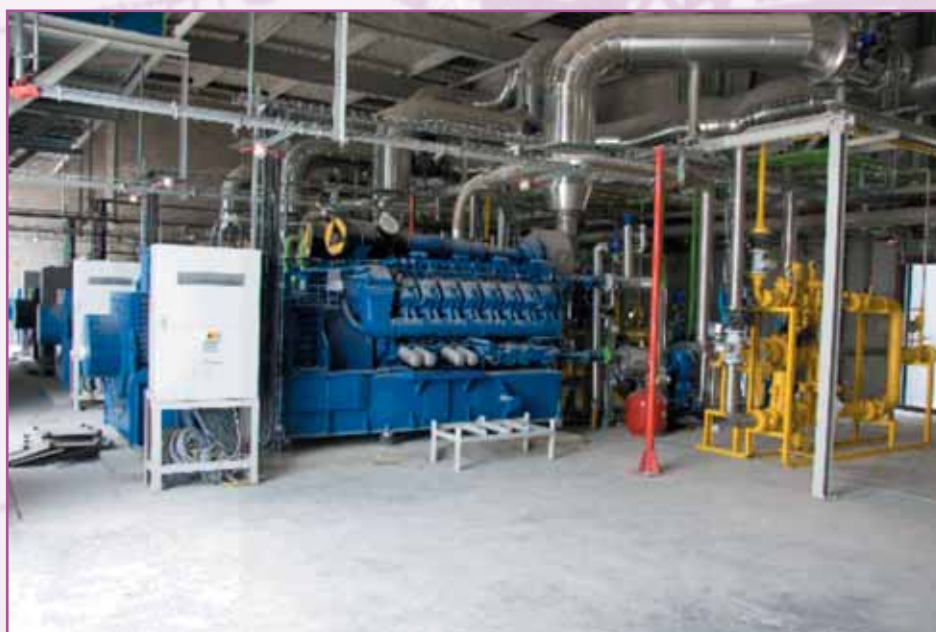
Central de biogás en PTR (Zaragoza).
