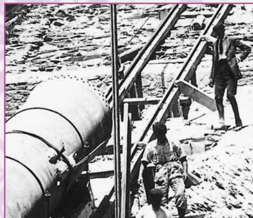
Montaje de tubos en la construcción de la central de Lafortunada (Huesca). Año 1918.
