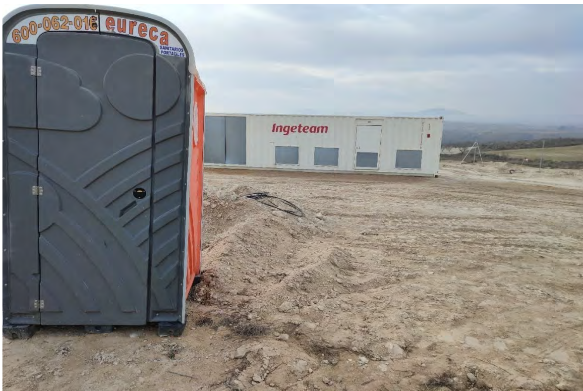
Fotografía 6. Baño químico temporal.
