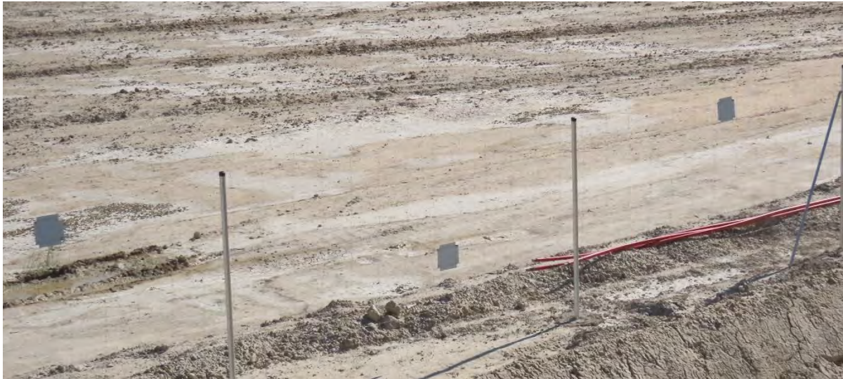
Ilustración 5. Vallado perimetral con elementos anticolidión.
