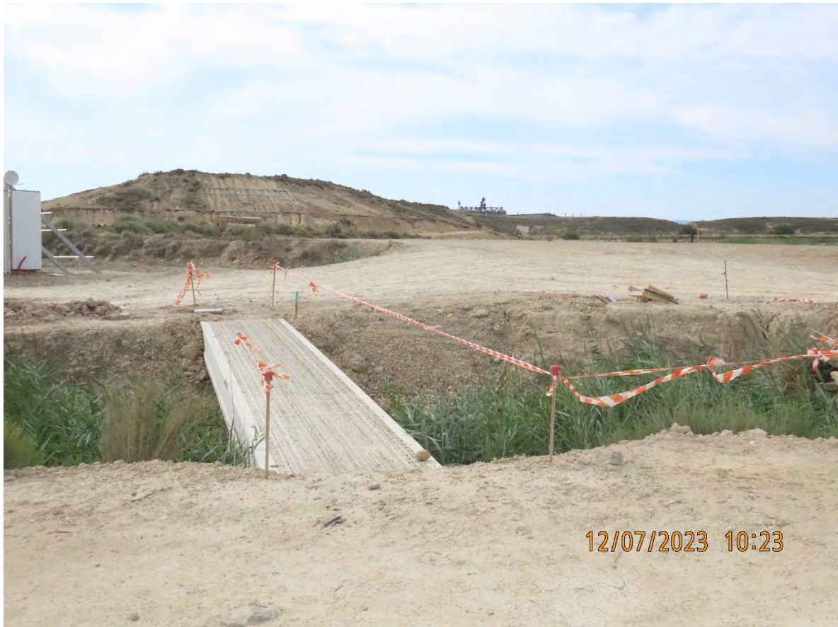
Ilustración 3. Bloques para el circuito eléctrico con su balizado.
