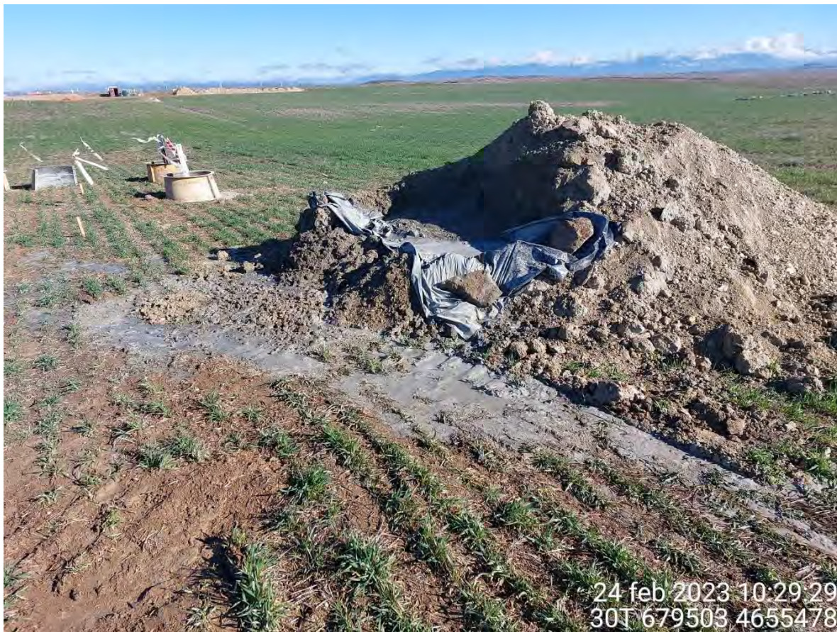
Imagen 1. Residuo de hormigón en el apoyo 39. Se debe recoger y gestionar como tal para no abrir una NC.
