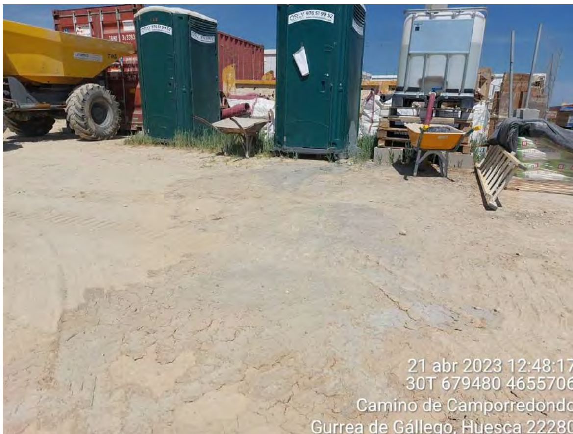
No conformidad 1. No conformidad leve en el punto limpio de TECINSA.
