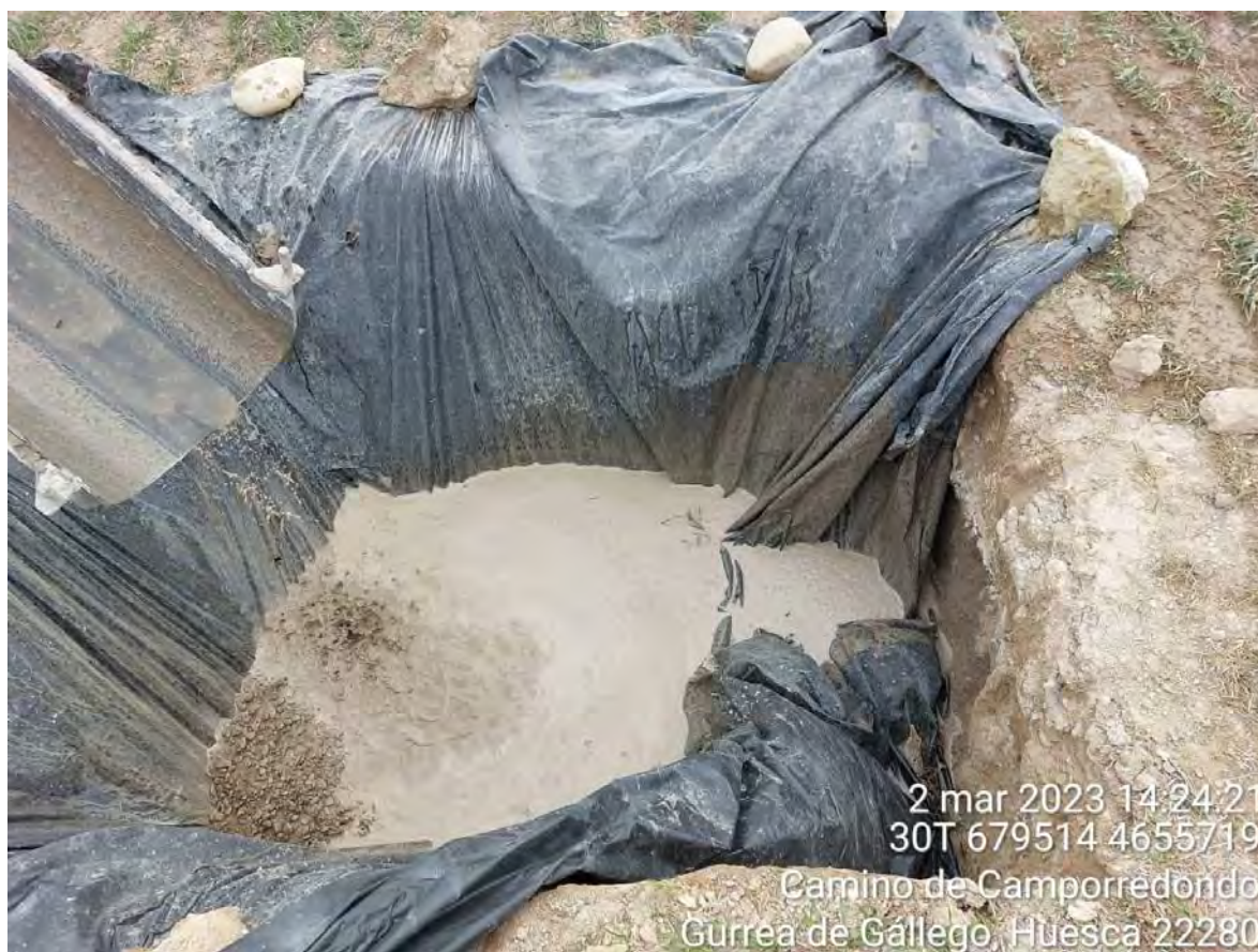
Imagen 1. Pozo de lavado en mal estado debido al levantamiento del plástico consecuencia del aire.
