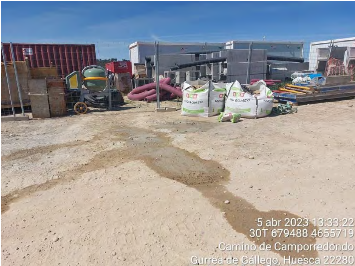
Imagen 1. Situación del punto limpio de TECINSA con mancha de hormigón en el suelo.
