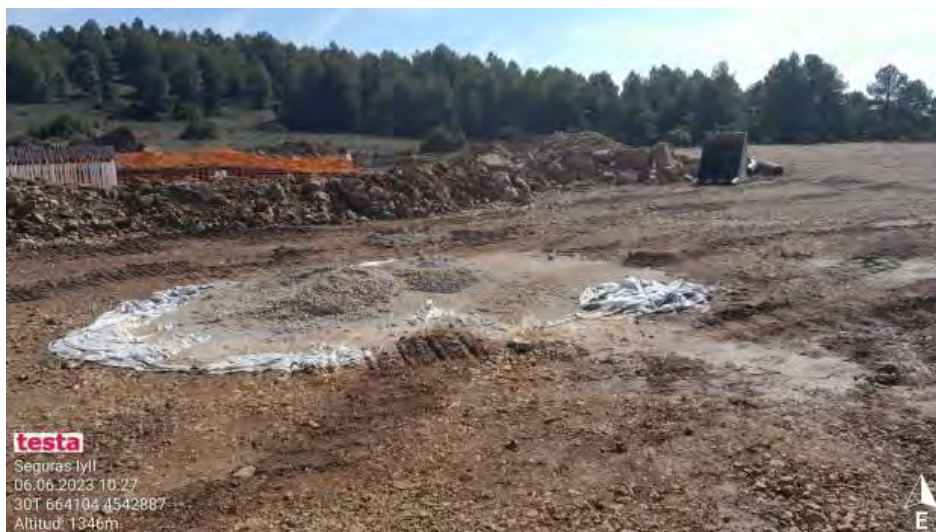
Aislamiento de hormigón con pequeño derrame
