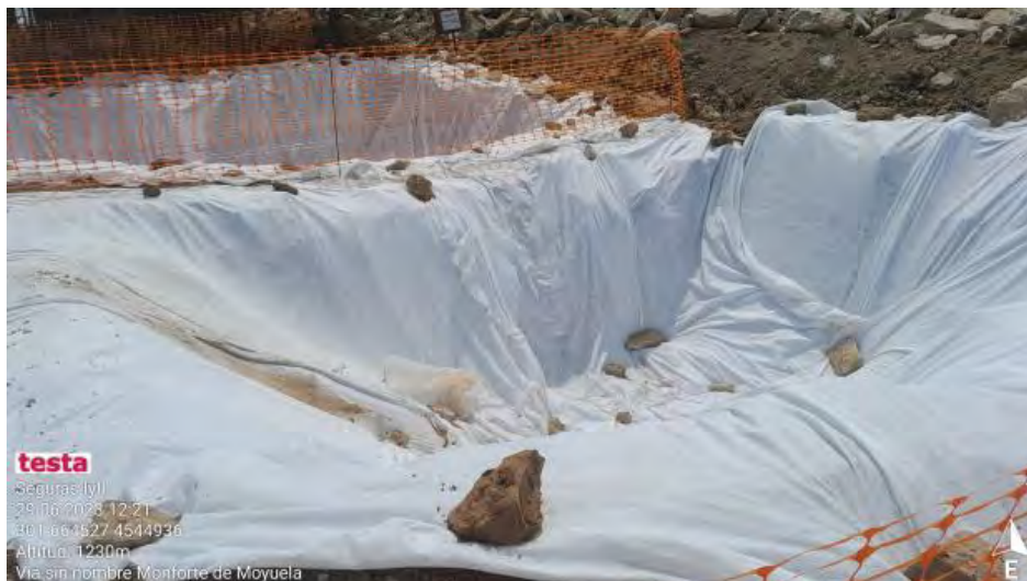
Pozo de lavado nuevo, en posición SE1-3
