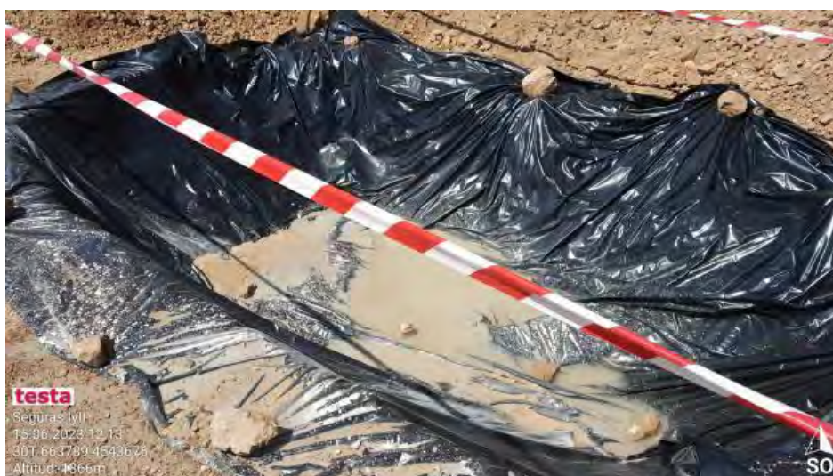
Pozo de lavado en SE1-1
