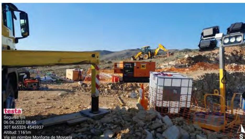
Aislamiento de suelo en bomba y otros equipos
