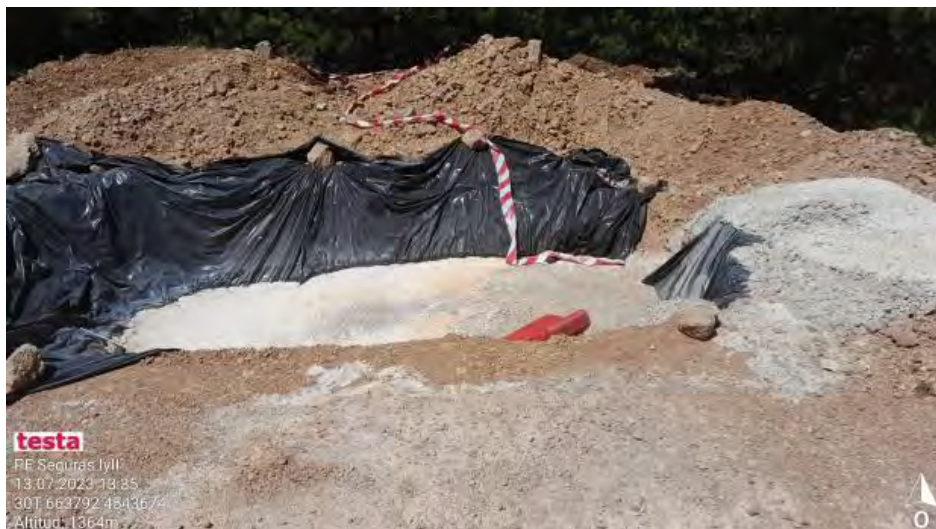
Pozos de lavado en SE1-1
