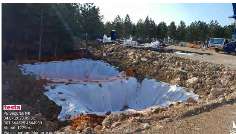
Pozos de lavado, en SE1-3
