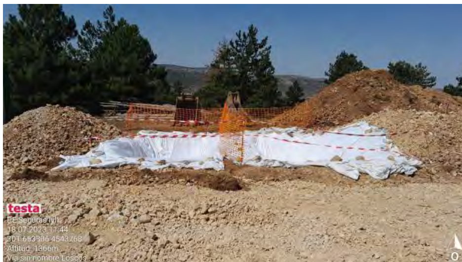
Pozos de lavado en SE1-1
