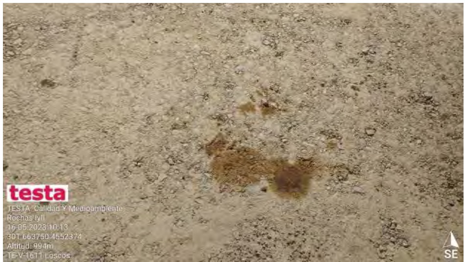
Derrame II en punto limpio
