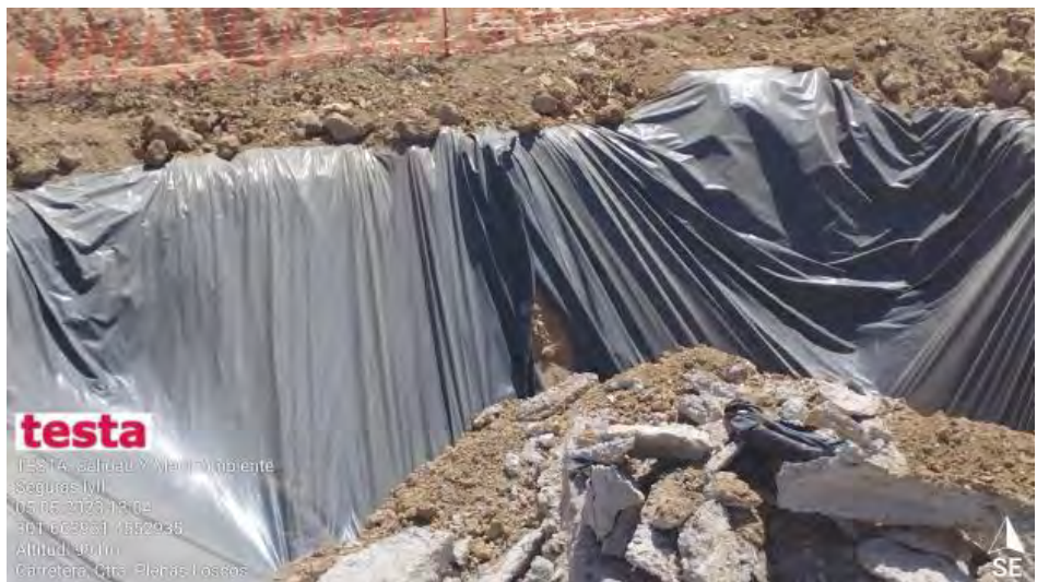
Pozo de lavado con rajas en la protección impermeabilizante.
