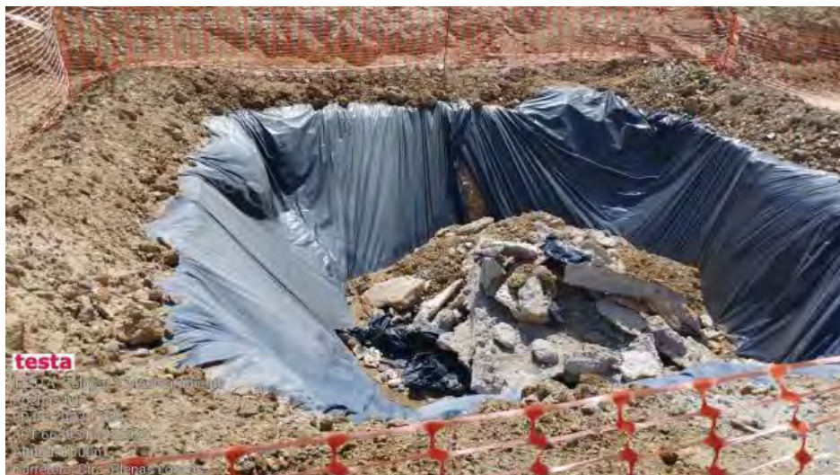
Pozo en mal estado y cerca del hormigonado de la zapata
