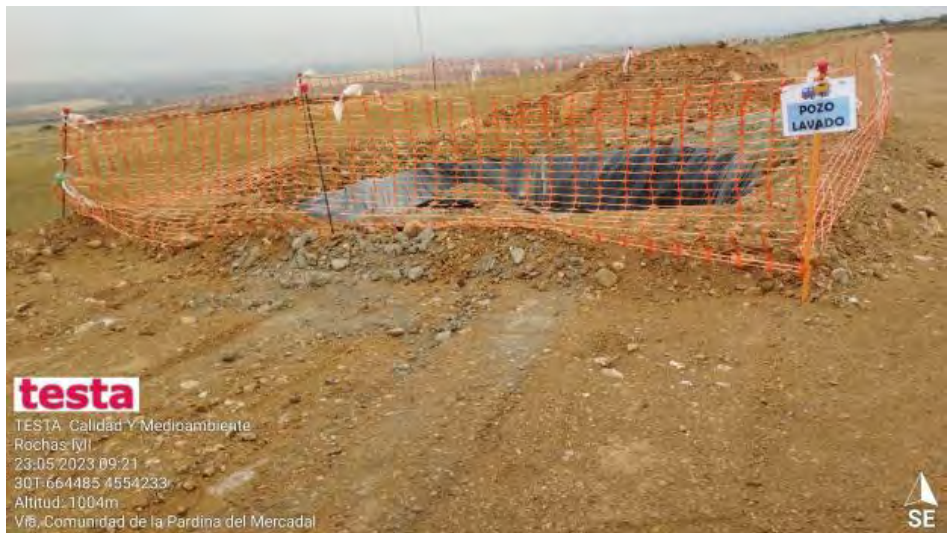
Limpiezas de hormigón deficientes.
