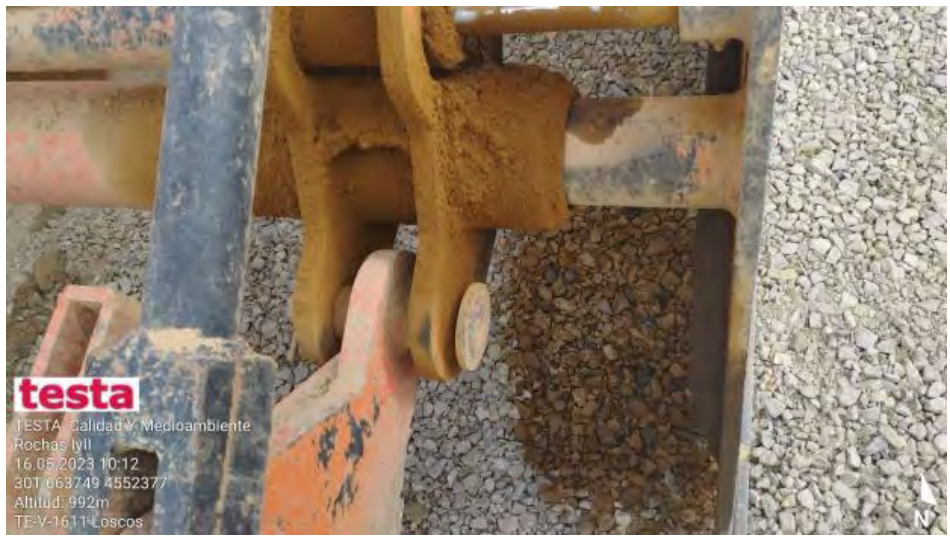
Derrame en punto limpio
