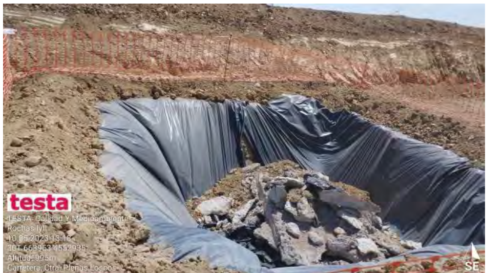
Pozo lavado sin corregir.
