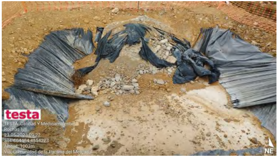
Pozo de lavado en mal estado.
