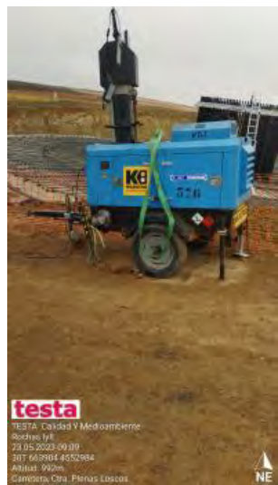
Generador sin bandejas y con fugas apreciables.
