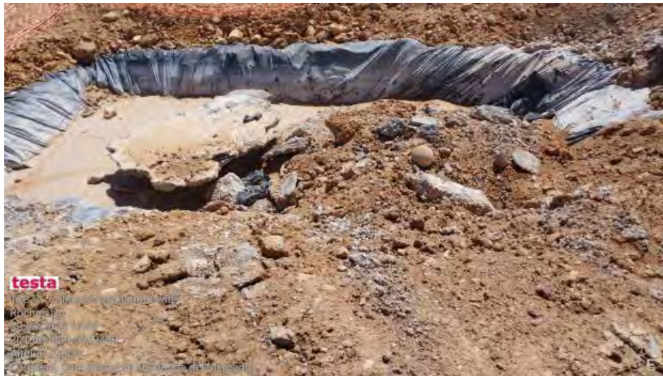
Limpieza y pozo de lavado en mal estado en RH2-4
