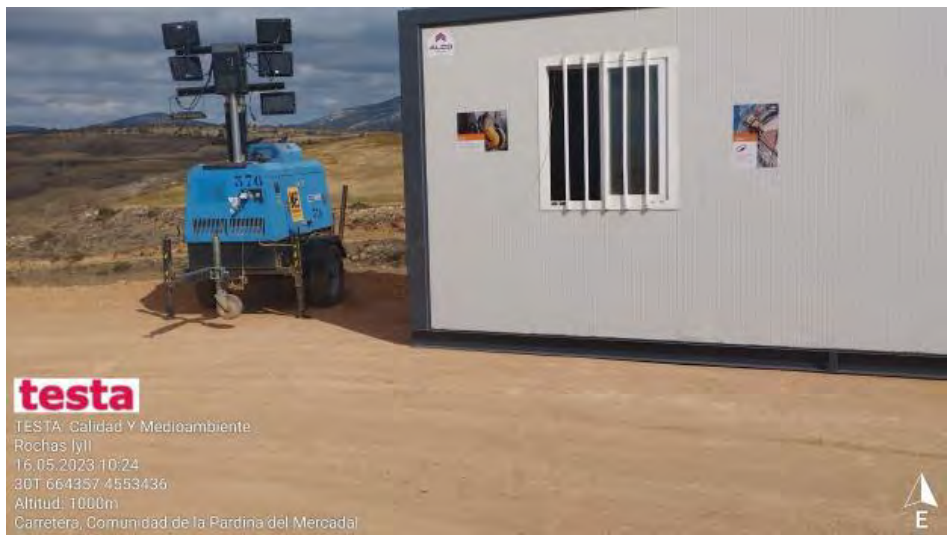
Generador sin bandejas y caseta sin elementos contra incendios
