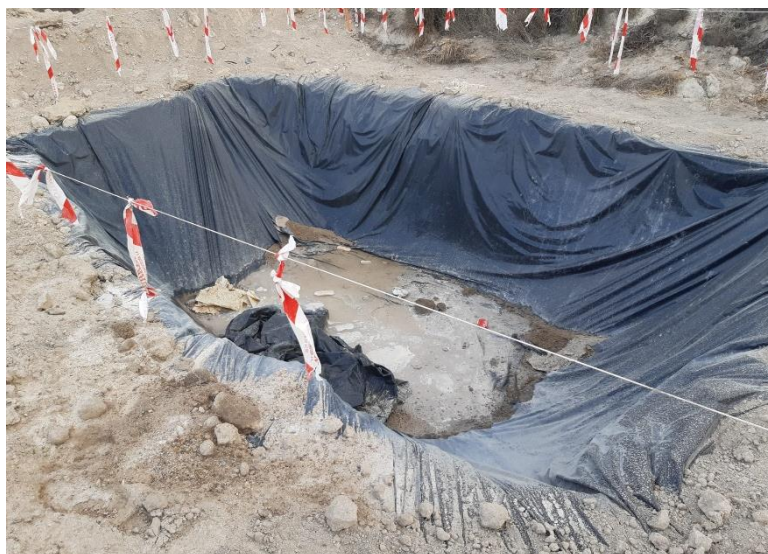
Figura 2: Zona de Lavado de cubas con impermeabilización en acceso a CAM-03.
