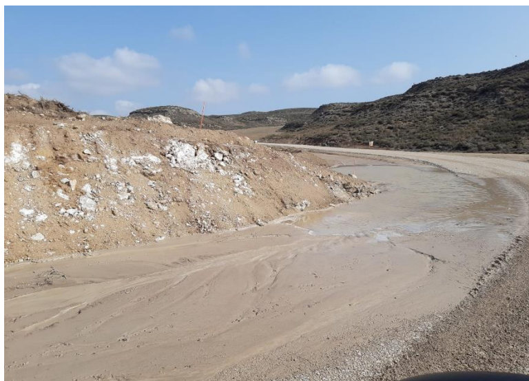
Figura 2: Inundación y sedimentos arrastrados por las lluvias en CAM-12.
