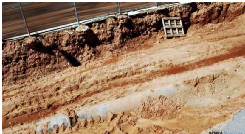
Tubería en la calle Doctrina/SN
