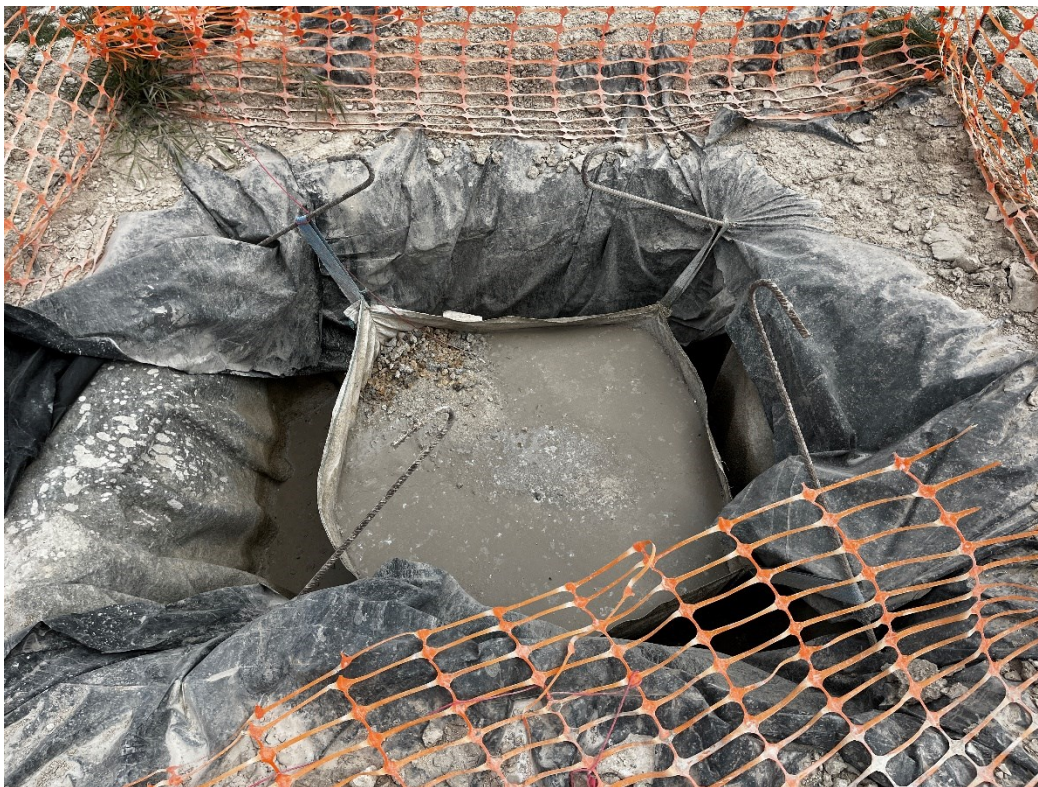
Figura 9 Lavadero de cubas de hormigón
