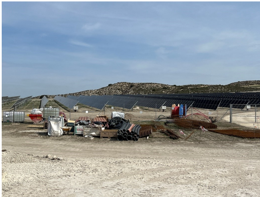
Figura 3 Acopio temporal de residuos no peligrosos dispuesto en la SET
