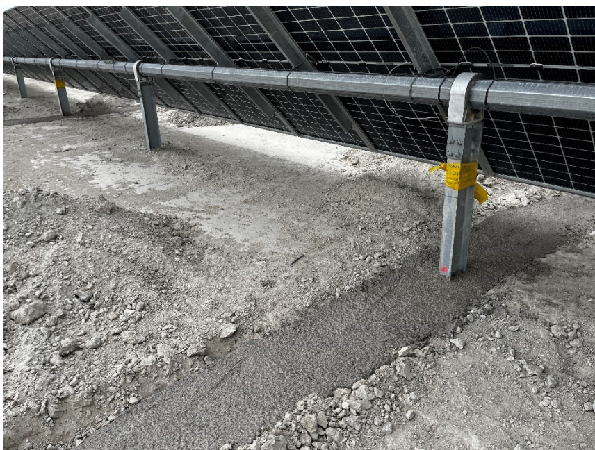
Figura 2 Cimentaciones de las hincas rechazadas
