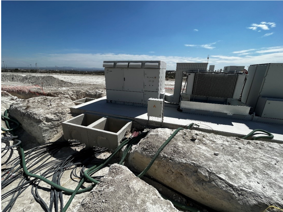
Figura 8 Cableado de los CT
