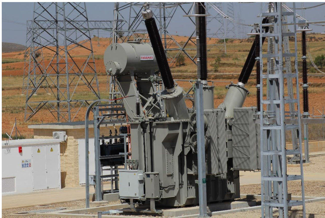
Foto 18. Vista del Trafo de la subestación.
