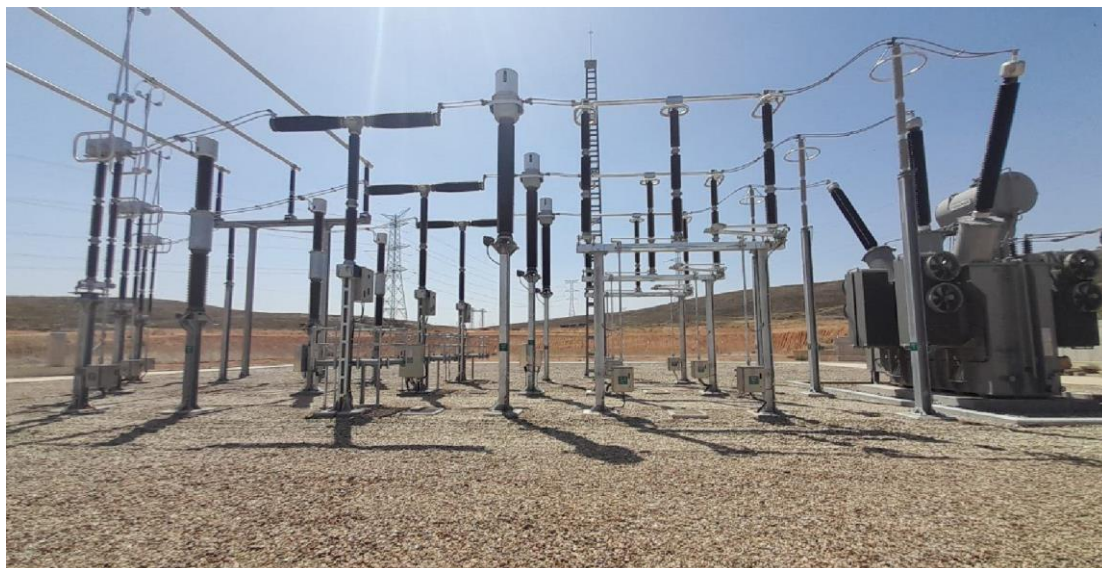
Foto 16. Vista general de la subestación.
