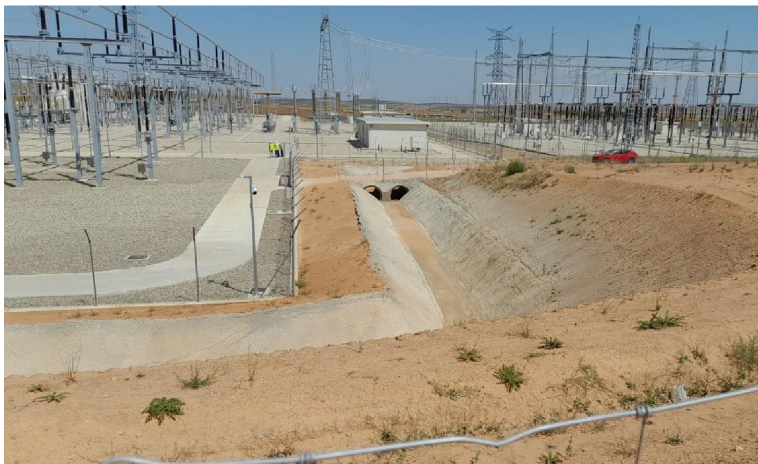
Foto 17. Vista general de la subestación. Enfoque en el sistema de drenaje.
