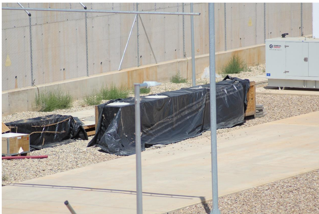
Foto 19. Almacenaje temporal de materiales (repuestos) dentro de la subestación.
