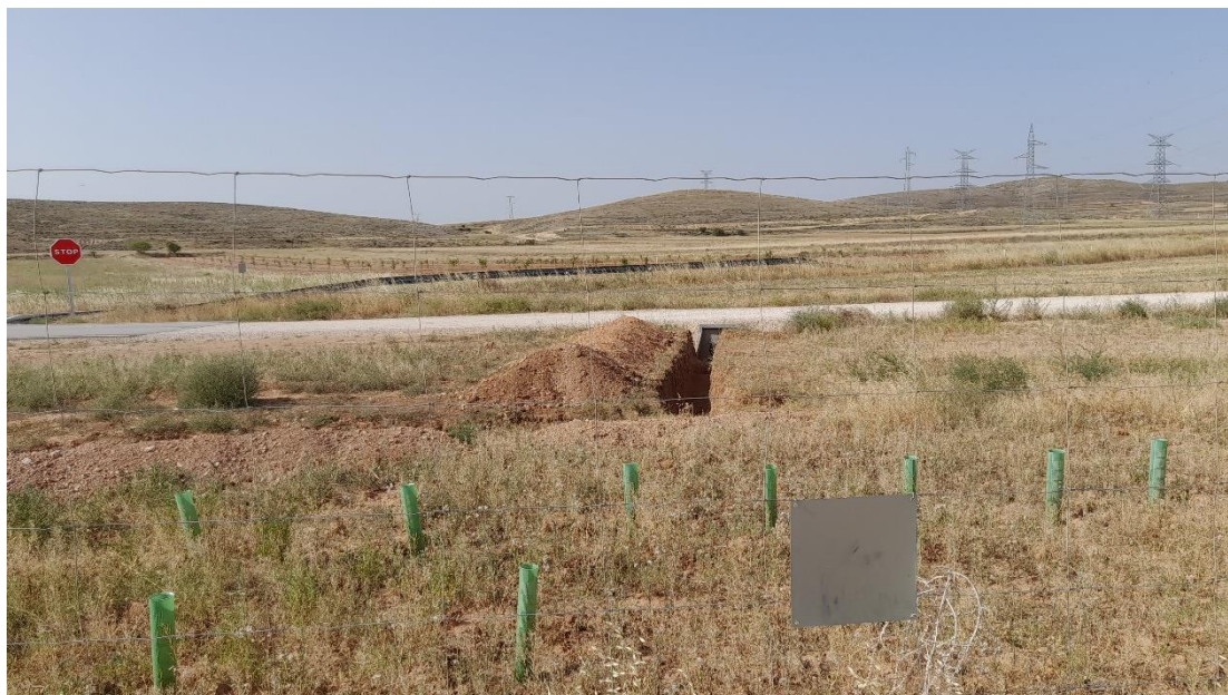
Foto 7. Sistema de drenaje en la zona contigua a la carretera A-2306 en el acceso a la planta fotovoltaica. Parte I.
