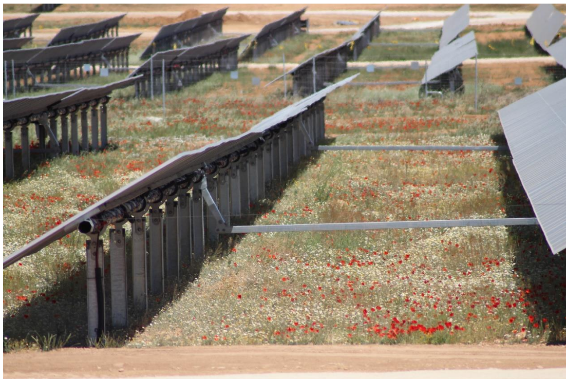
Foto 11. Aspecto de zona de seguidores cubierta con vegetación.
