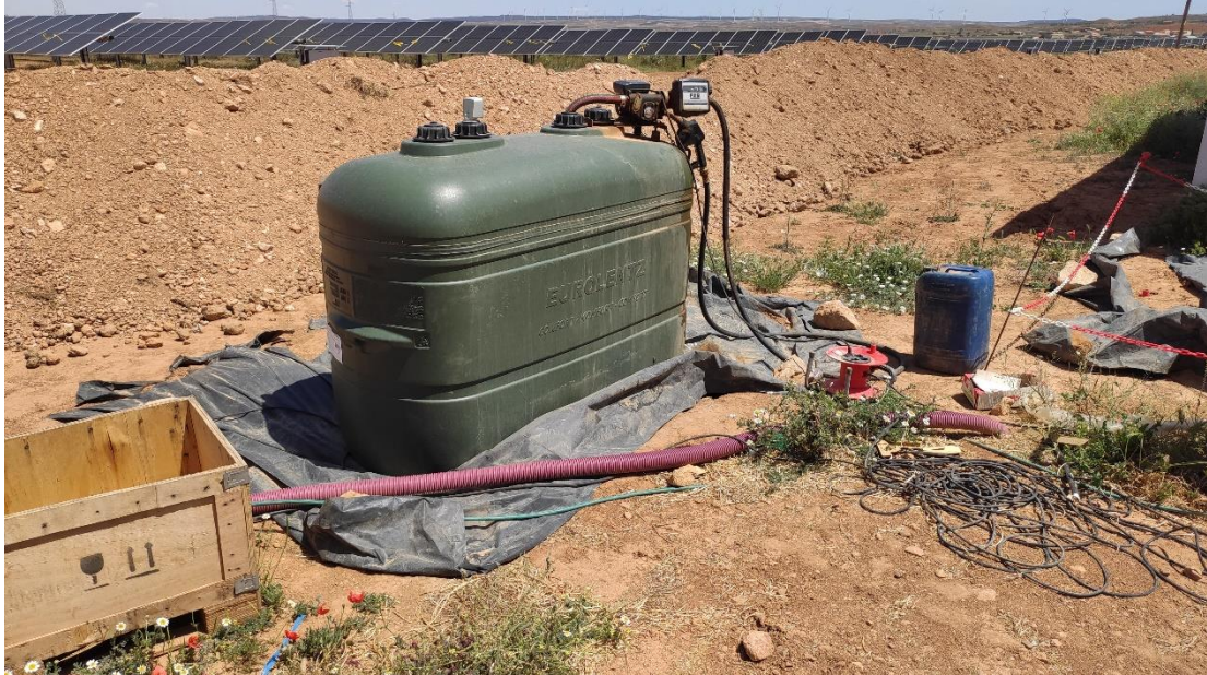
Foto 5. Depósito de gasoil en la zona de oficinas e instalaciones auxiliares.
