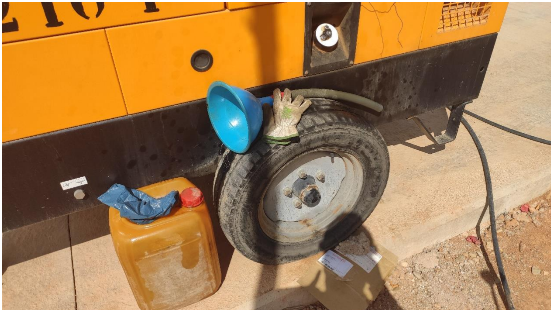
Foto 22. Grupo electrógeno en zona de obra.
