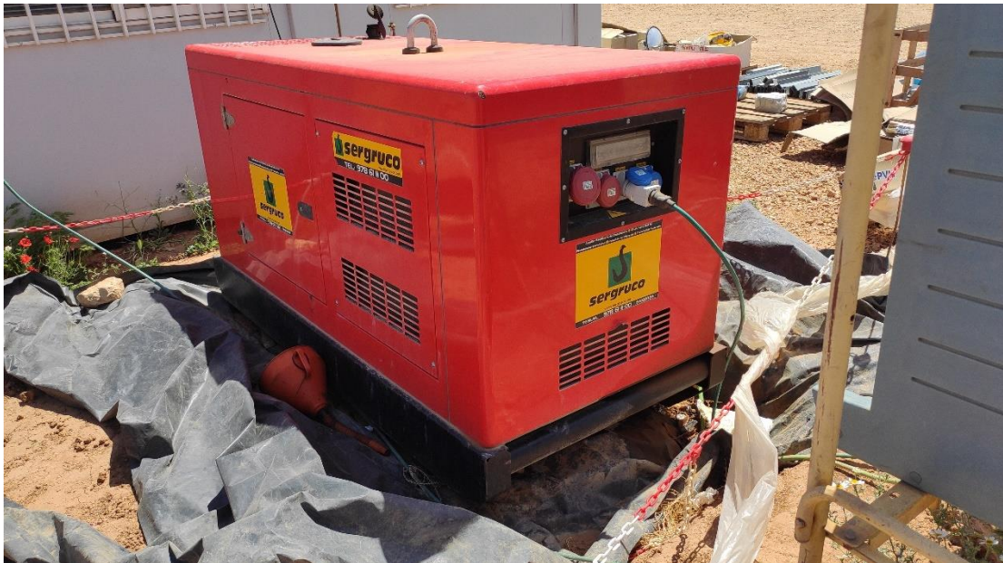
Foto 6. Grupo electrógeno en la zona de oficinas e instalaciones auxiliares.
