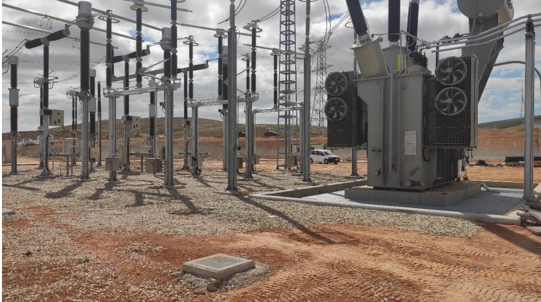
Foto 21. Vista general de la subestación.
