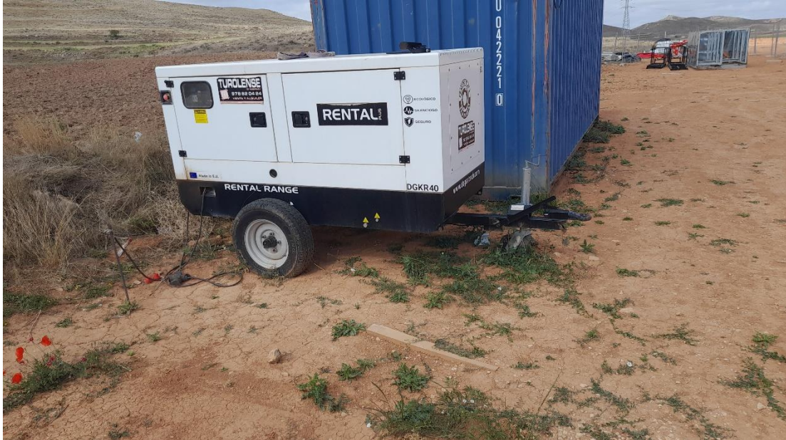
Foto 17. Grupo electrógeno y almacén en zona SET
