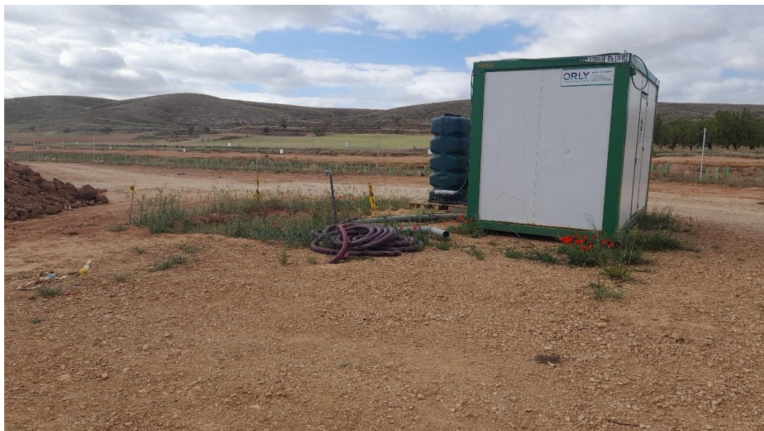
Foto 7. Depósitos de agua en baños de obra. Uno de los baños ya ha sido desmantelado
