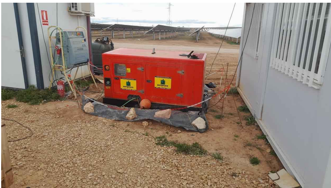
Foto 6. Grupo electrógeno en la zona de oficinas e instalaciones auxiliares.
