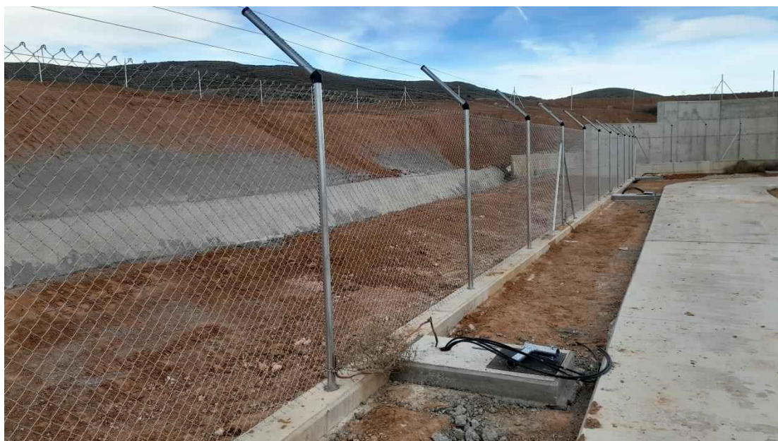
Foto 24. Cuneta de drenaje perimetral y apreciación de los vallados cinegético y perimetral definitivos.
