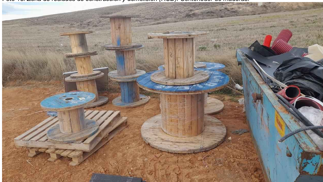
Foto 16. Zona de residuos de construcción y demolición (RCD). Restos de bobinas del cableado.
