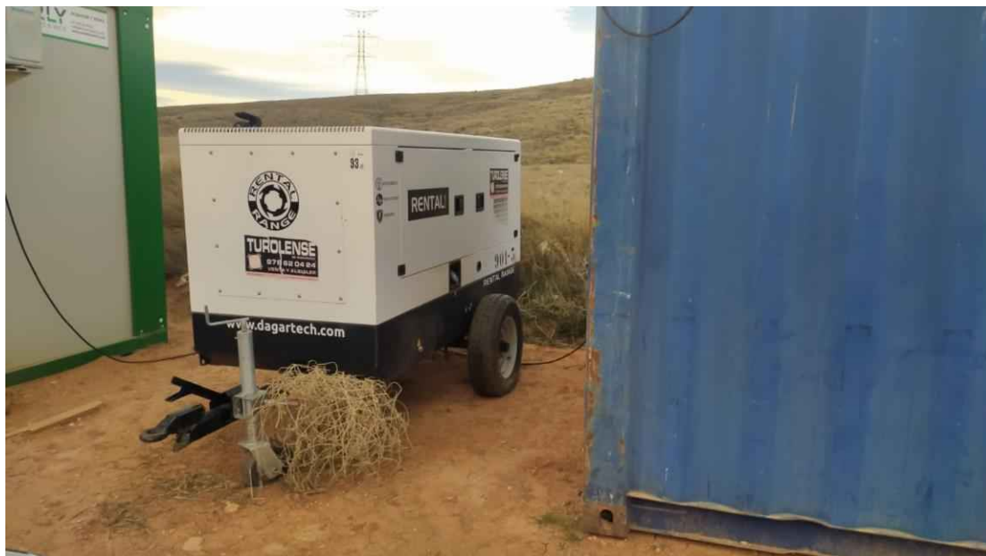
Foto 19. Grupo electrógeno en la zona de oficinas.
