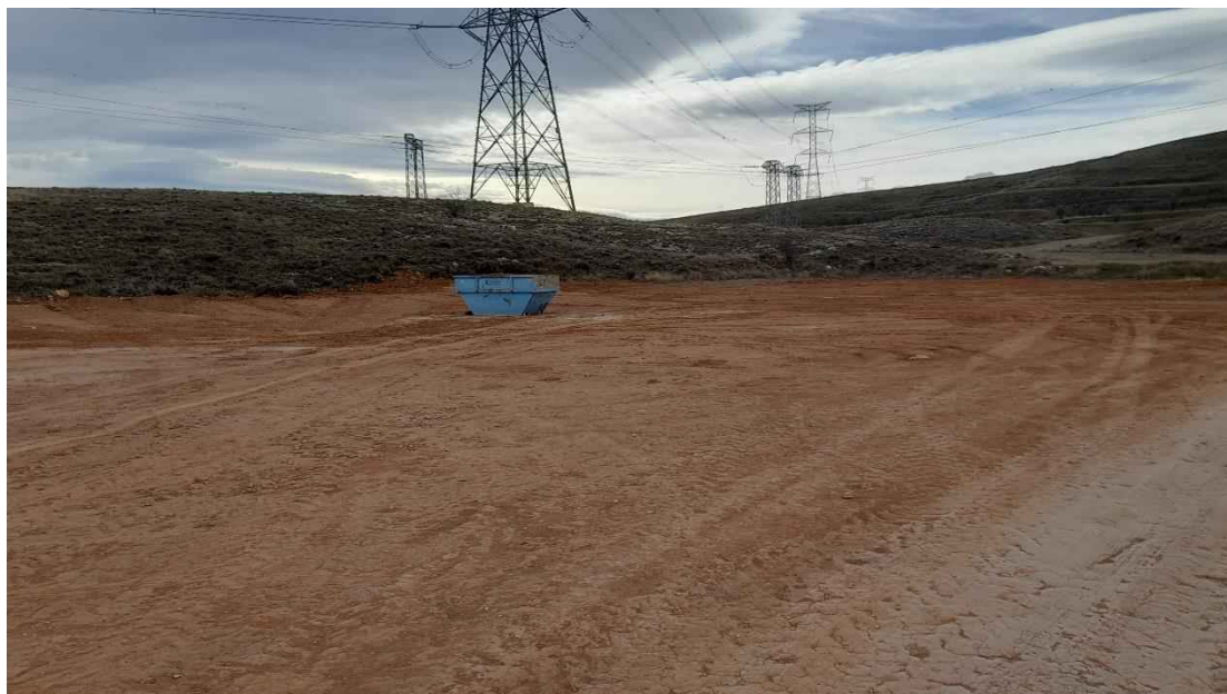
Foto 21. Contenedor para el lavado de canaletas de cubas hormigoneras y restos de hormigón fresco.
