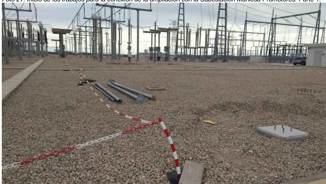
Foto 28. Inicio de los trabajos para la conexión de la ampliación con la Subestación Muniesa Promotores. Parte 2.
