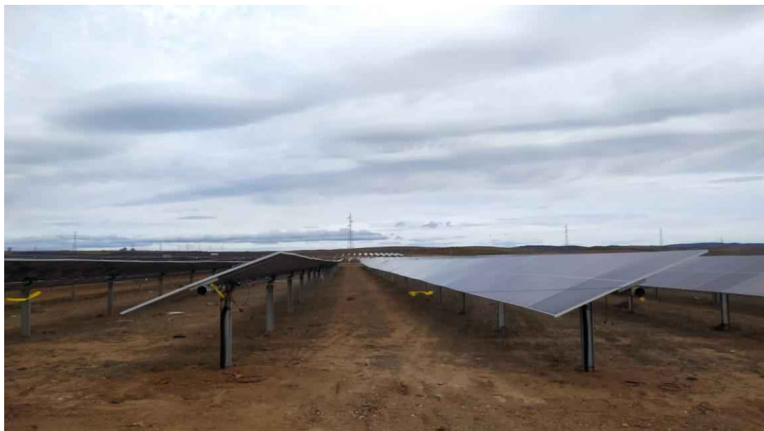
Foto 13. Vista general de zona con seguidores con paneles montados. Parte 3. Apreciación de señalización entre filas para evitar contacto eléctrico.
