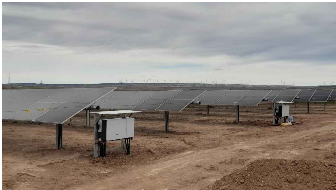
Foto 12. Vista general de zona con seguidores con paneles montados. Parte 2. Apreciación de señalización entre filas para evitar contacto eléctrico.
