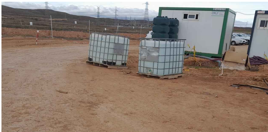
Foto 7. Depósitos de fosa séptica y agua sanitaria.
