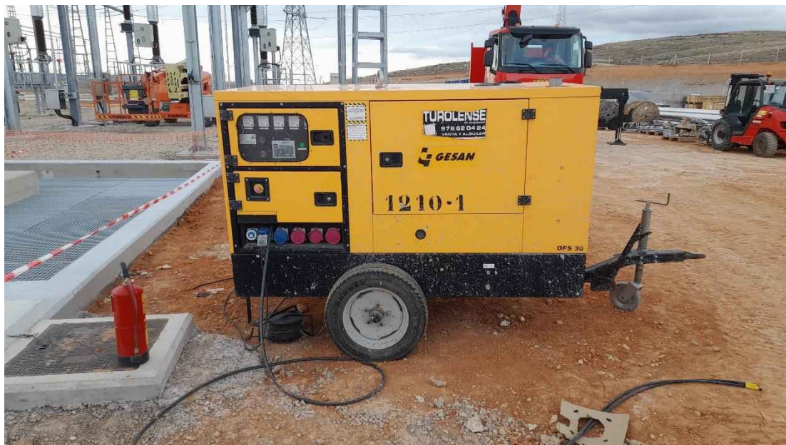
Foto 23. Grupo electrógeno en zona de obra.
