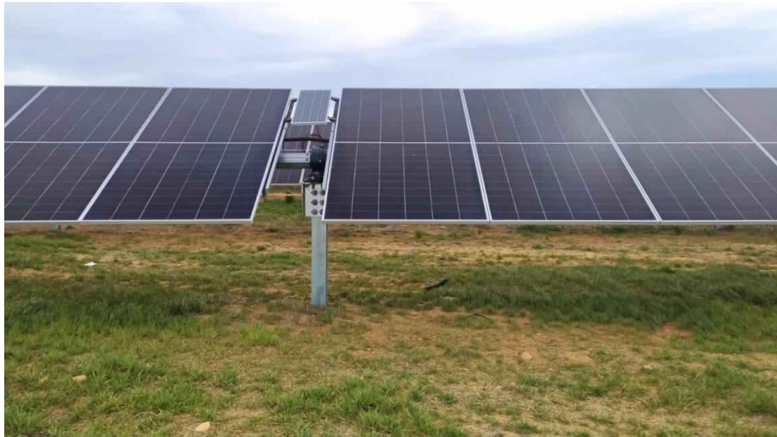
Foto 11. Vista general de zona con seguidores con paneles montados. Parte 1. Apreciación de una pequeña cubierta vegetal.
