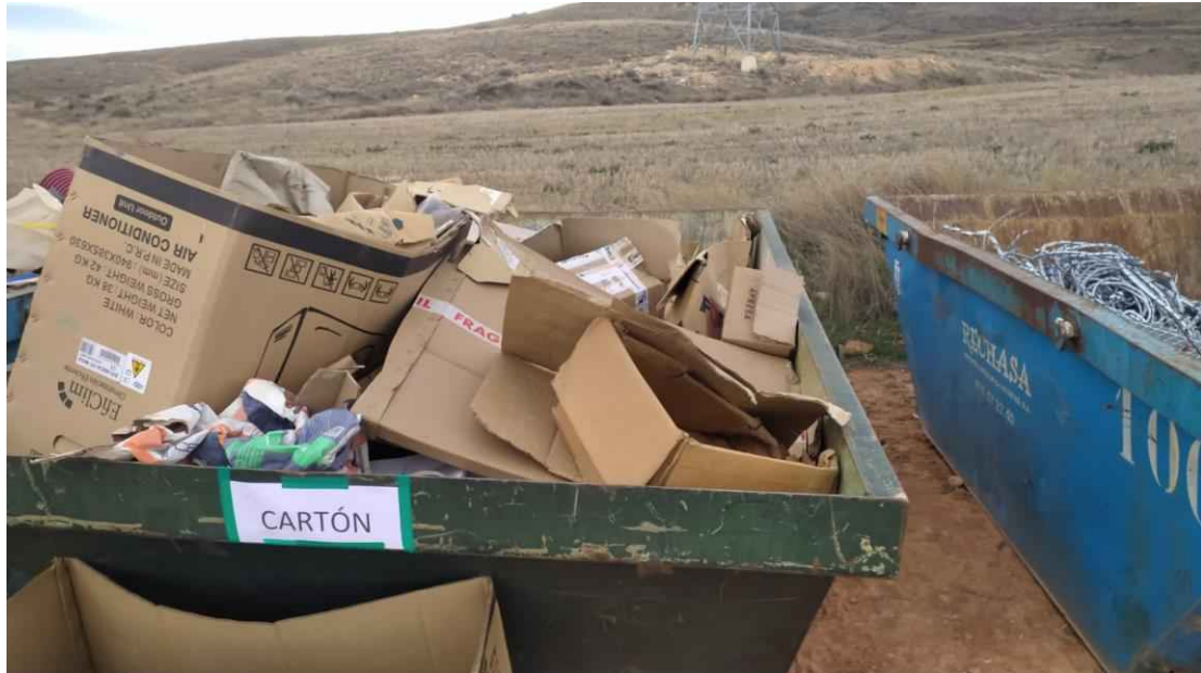
Foto 16. Zona de residuos de construcción y demolición (RCD). Contenedor de papel y cartón.
